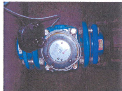
Photo 13 : Compteur pompage Bas-Service
