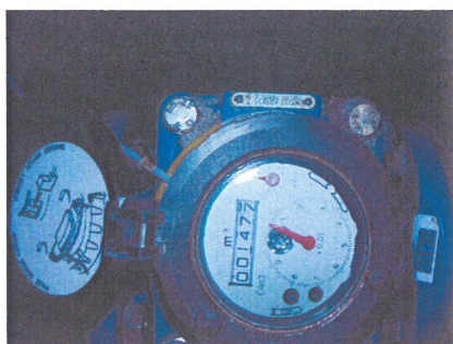
Photo 3 : Compteur arrivée source du Borbieu
