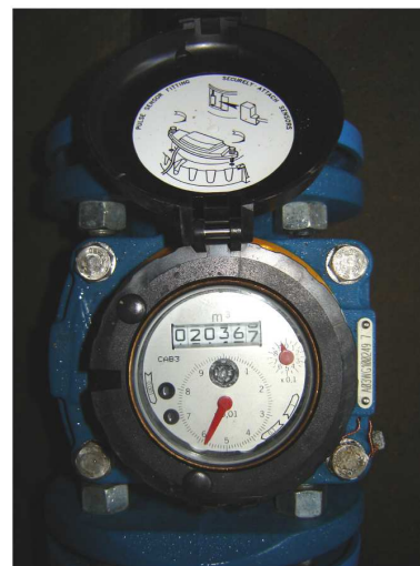
Compteur d'alimentation du réservoir du Pichet
