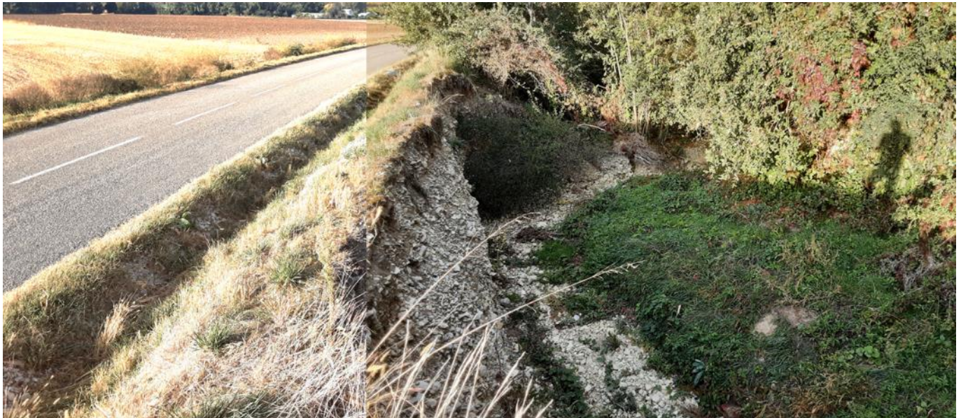
Illustration 58 : Érosion de berge en rive gauche de la Boisse sur la commune de Charpey – BOIS_3C (le long de la RD119)
