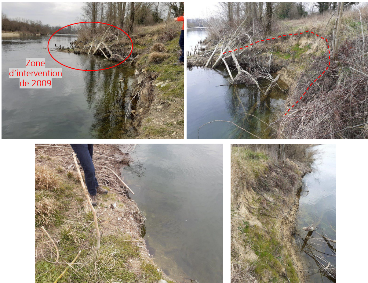
Figure 7 : Erosions de berges en partie Nord du site
