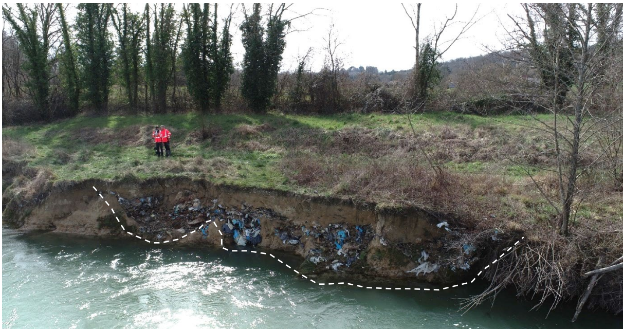
Figure 21 : Etat des berges en partie aval du site, mars 2023, Villette sur Ain – source : Référence B
