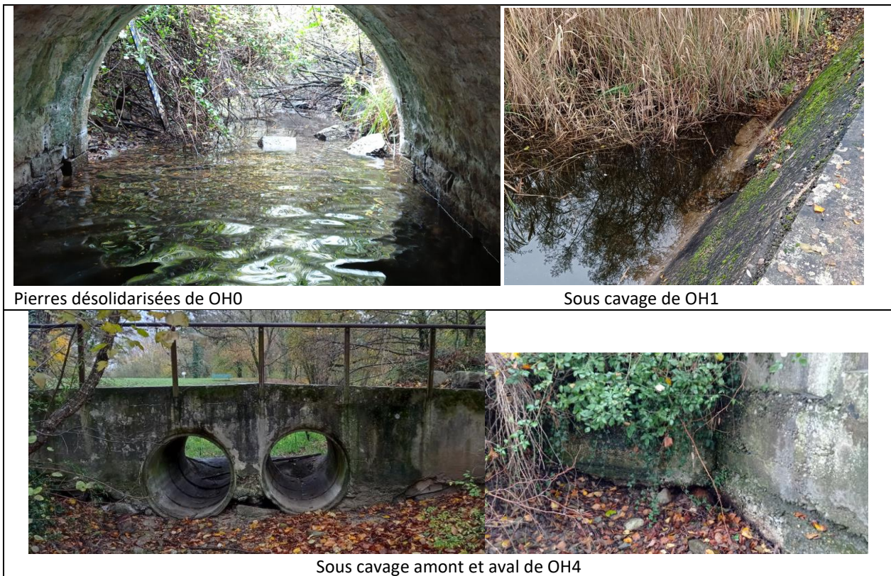
Figure 86 : Désordres structuraux des ouvrages
