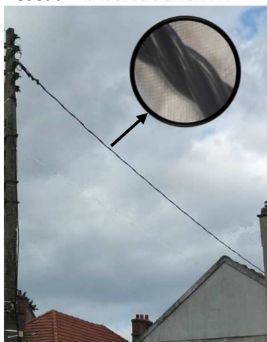
Réseau fils isolés aérien BT
