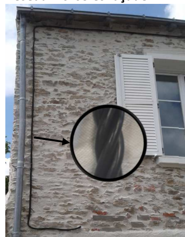
Réseau fils isolés façade BT
