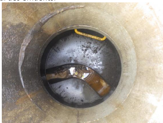
Dépôts altérant l'écoulement– Route de Cruzilles– ID
