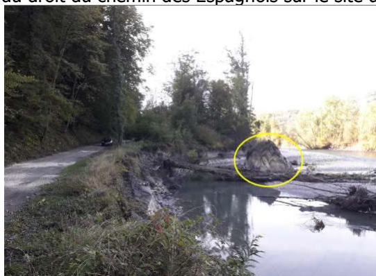
Figure 160 : Erosion de berges au droit du chemin des Espagnols
