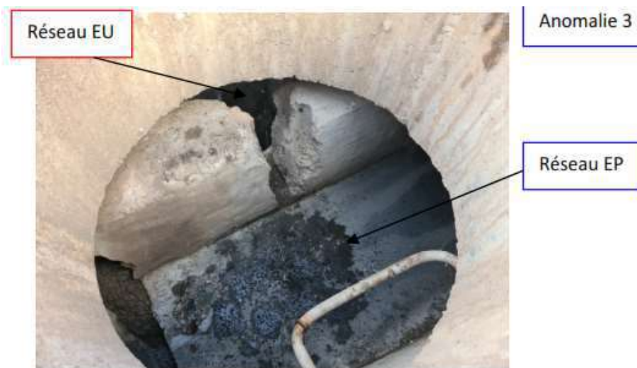
Figure 15: Perouse: Regard endommagé rue des Saules (R94)
