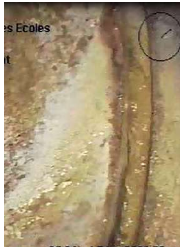
Infiltration importante au niveau du déboitement
