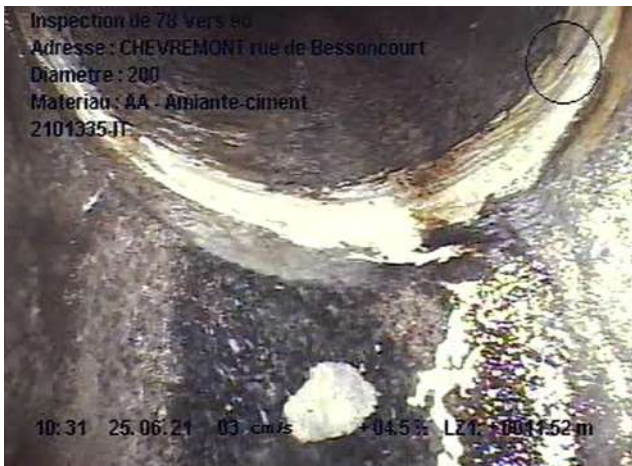
Branchement suspecté productif (Tronçon 78-96)
