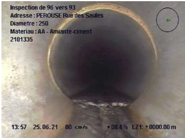
Fissure circulaire ouverte (Tronçon 96-93)
