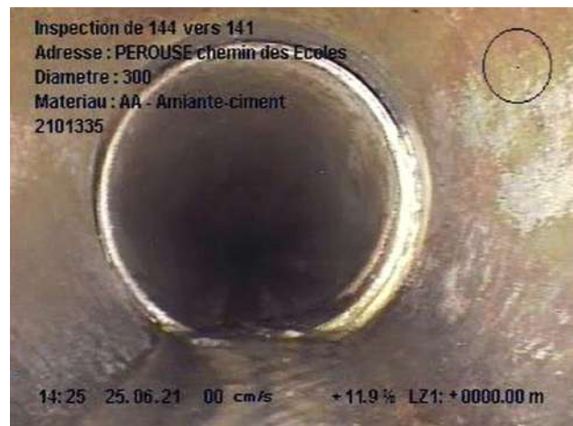
Déboitement désaxé (Tronçon 144-141)
