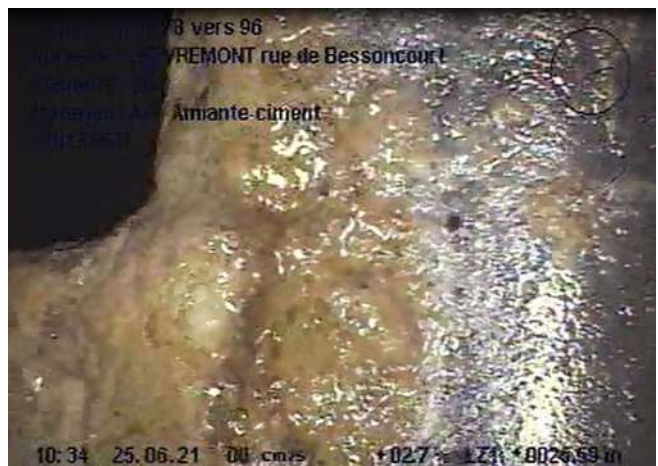
Infiltration en liaison buse/regard (Tronçon 78-96)
