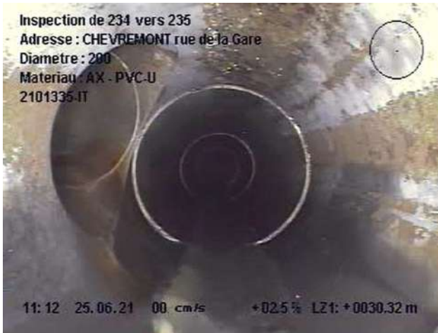
Arrivée d'eaux claires par branchement suspectée (Tronçon 234-235)
