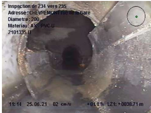
Obstacle en liaison buse/regard (Regard 235)
