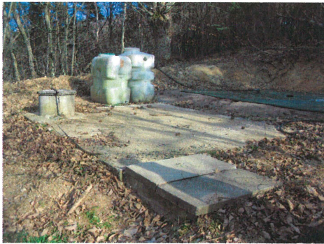
Vue extérieure réservoir
