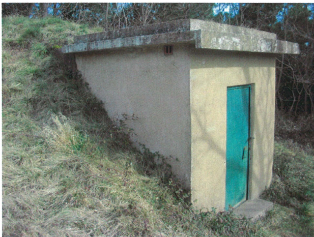
Vue extérieure réservoir
