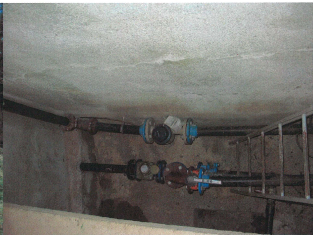
Vue intérieure (compteurs)
