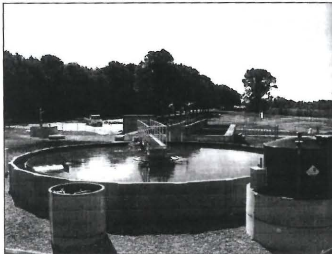
Fig. 7-i : Station d'épuration à boues activées – 2500 EH (Source : SATESE de la Nièvre)
