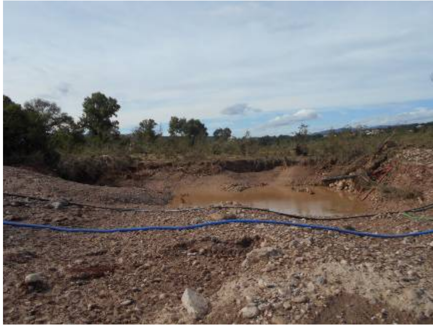
Exemple de tronçon où la digue a totalement disparue - crue du 12-13/09/2015
