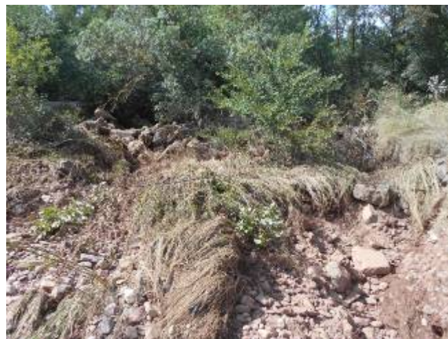
Quatrième brèche dans la digue - post-crue du 23/08/2015
