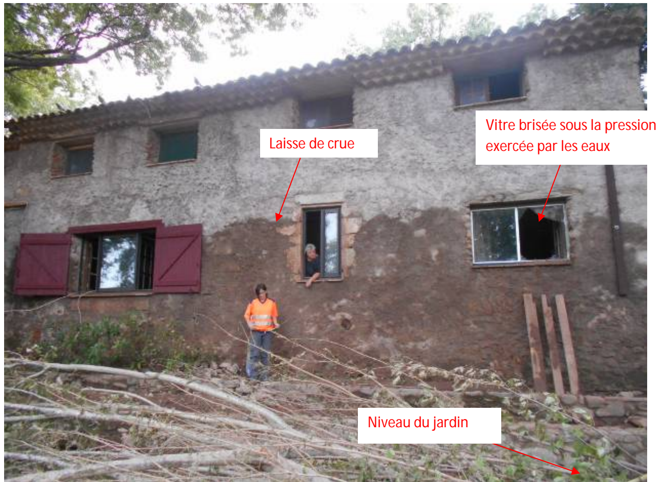
Niveau atteint par les eaux au Mas Tournal (crue du 12-13/09/2015) : 2.80 m par rapport au chemin longeant l'habitation, 3.70 m par rapport au jardin
