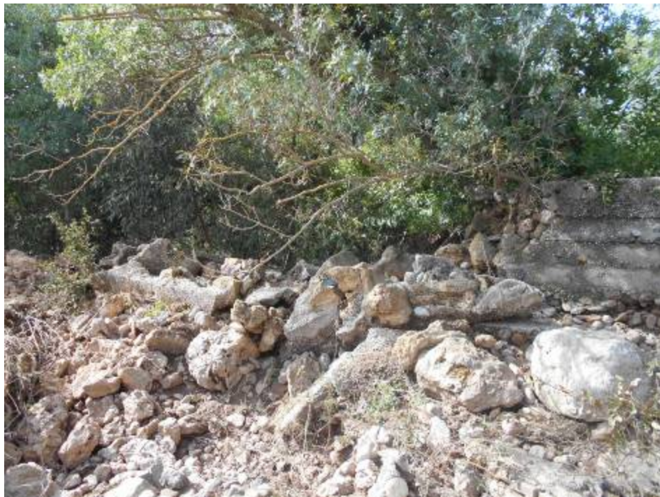
Illustration de l'état délabré de la digue
