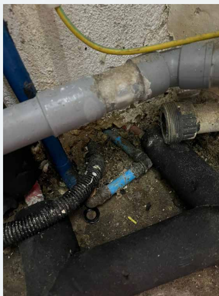
Suspicion de fuite sur alimentation de diamètre 16 Per
