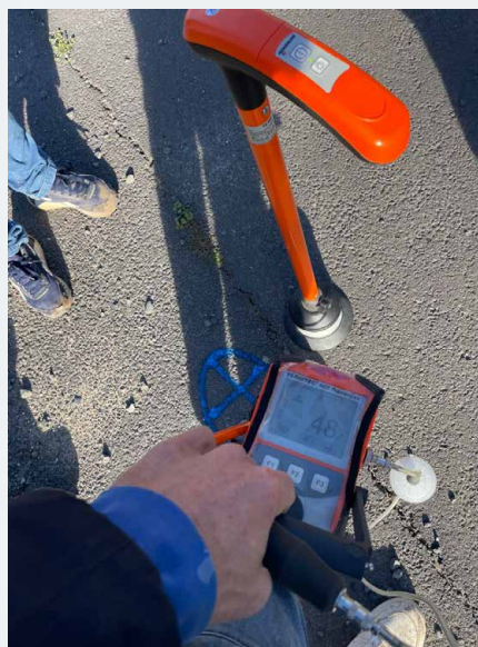
Présence de gaz donc suspicion de fuite.
