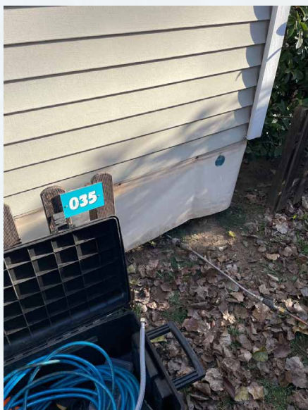
Injection gaz par arrivée du mobil home
