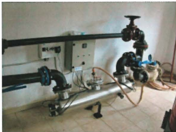
Dispositif de traitement UV de Savel
