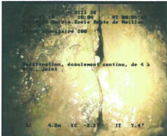
Photo: 0000053.JPG, 00:01:04 4,24m, Infiltration, écoulement continu, de 4 à 8 h., joint
