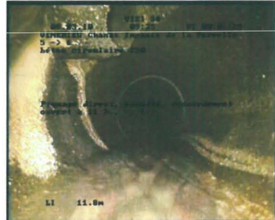
Photo: 0000045.JPG, 00:01:28 11,97m, Piquage direct, carotté, raccordement ouvert à 11 h., -, (-)
