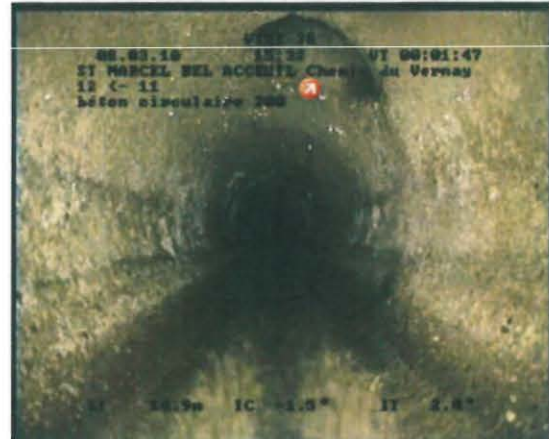
Photo: 0000066.JPG, 00:01:38 15,25m, Piquage direct, carotté, raccordement ouvert à 1 h., -, (-)
