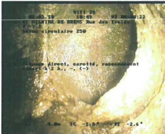
Photo: 0000007.JPG, 00:00:21 4,08m, Piquage direct, carotté, raccordement ouvert à 2 h., -, (-)
