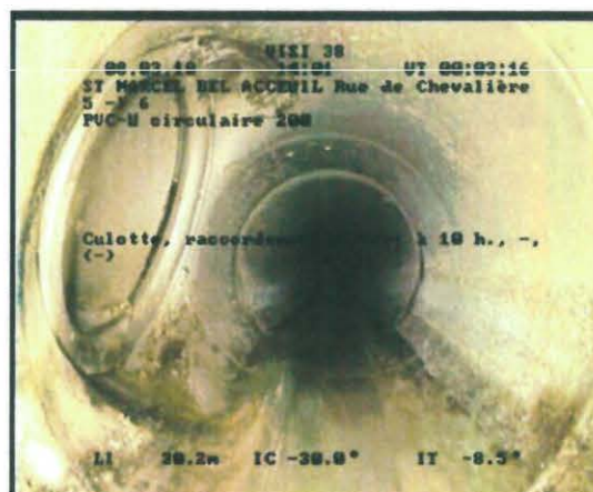
Photo: 0000028.JPG, 00:03:15 30,47m, Culotte, raccordement ouvert à 10 h., -, (-)
