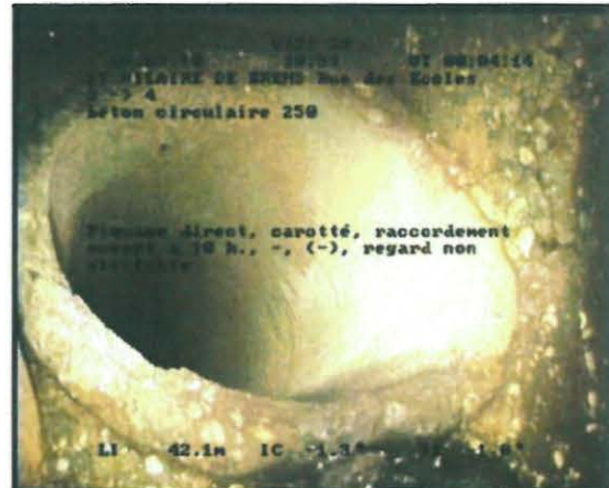
Photo: 0000024.JPG, 00:04:14 42,15m, Piquage direct, carotté, raccordement ouvert à 10 h., -, (-)
