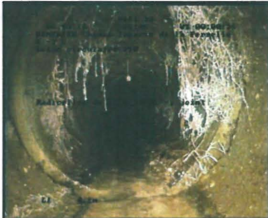
Photo: 0000001.JPG, 00:00:35 4,37m, Radicelles de 12 à 12 h. -, joint
