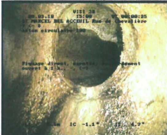
Photo: 0000039.JPG, 00:00:25 5,68m, Piquage direct, carotté, raccordement ouvert à 1 h., -, (-)
