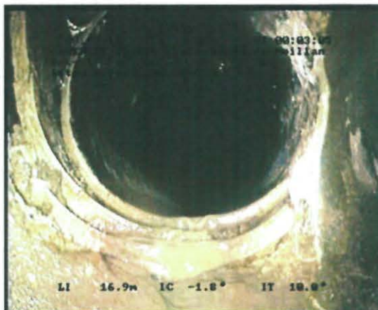
Photo: 0000059.JPG, 00:02:58 16,99m, Piquage direct, carotté, raccordement ouvert à 10 h., -, (-)
