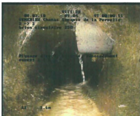
Photo: 0000013.JPG, 00:00:49 4m, Piquage direct, carotté, raccordement ouvert à 1 h., -, (-)
