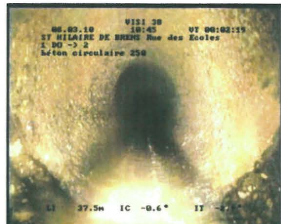
Photo: 0000004.JPG, 00:02:12 37,54m, Piquage direct, buriné, raccordement ouvert à 2 h., -, (-)
