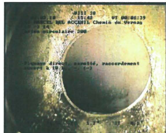
Photo: 0000076.JPG, 00:01:35 24,56m, Piquage direct, caroté, raccordement ouvert à 10 h., -, (-)
