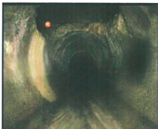
Photo: 0000053.JPG, 00:01:13 15,26m, Piquage direct, carotté, raccordement ouvert à 11 h., -, (-)
