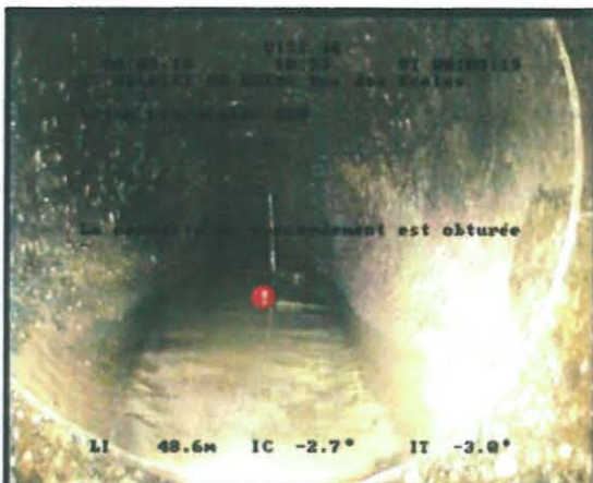
Photo: 0000013.JPG, 00:03:17 48,63m, La conduite de raccordement est obturée -
