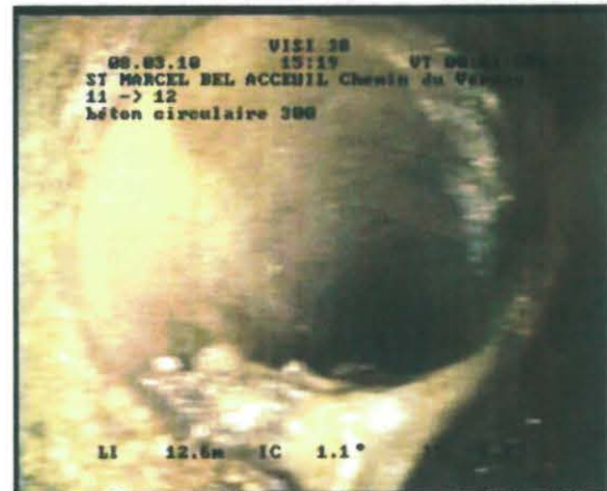
Photo: 0000059.JPG, 00:00:48 12,7m, Piquage direct, carotté, raccordement ouvert à 2 h., -, (-)
