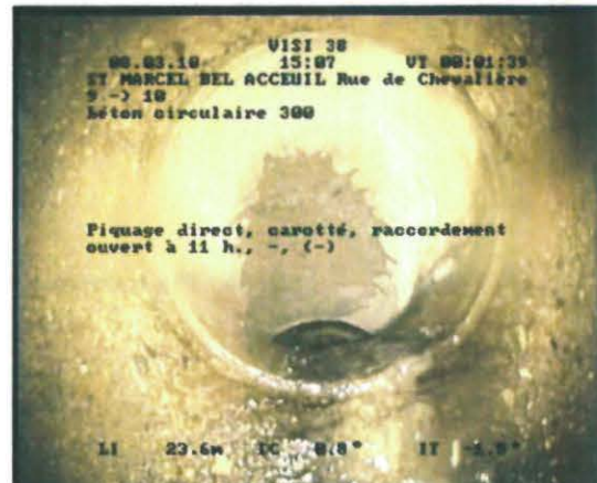
Photo: 0000047.JPG, 00:01:38 23,69m, Piquage direct, carotté, raccordement ouvert à 11 h., -, (-)
