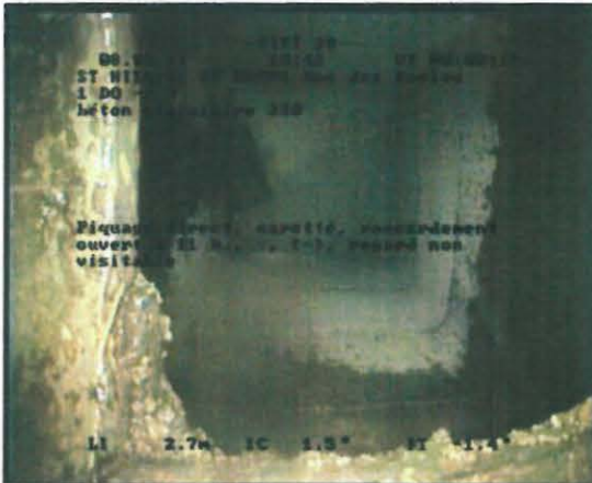
Photo: 0000001.JPG, 00:00:17 2,79m, Piquage direct, carotté, raccordement ouvert à 11 h., -, (-)
