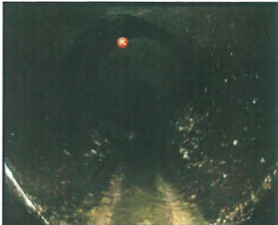
Photo: 0000090.JPG, 00:01:55 14,24m, Piquage direct, carotté, raccordement ouvert à 11 h., -, (-)
