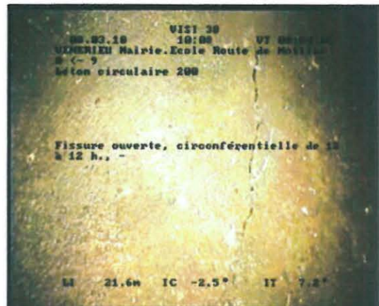
Photo: 0000064.JPG, 00:04:07 21,6m, Fissure ouverte, circonférentielle de 12 à 12 h., -
