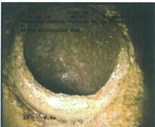
Photo: 0000007.JPG, 00:01:35 9,9m, Piquage direct, carotté, raccordement ouvert à 10 h., - (-)
