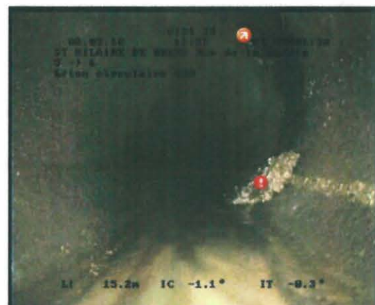
Photo: 0000032.JPG, 00:01:28 15,68m, Dépôts de matériau dur ou compacté sur le radier de 4 à 5 h. -
