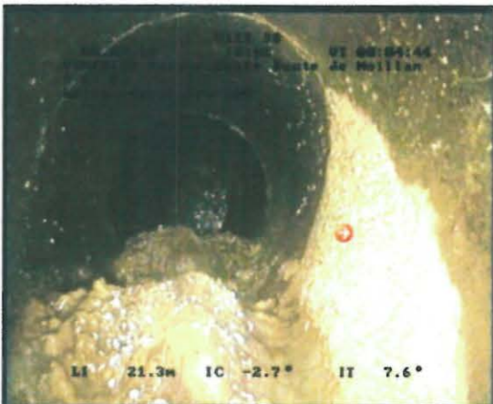
Photo: 0000063.JPG, 00:04:35 21,52m, Dépôts adhérents, concrétions de 2 à 5 h. -
