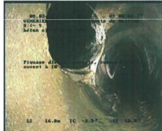
Photo: 0000058.JPG, 00:02:58 16,99m, Piquage direct, carotté, raccordement ouvert à 10 h., -, (-)
