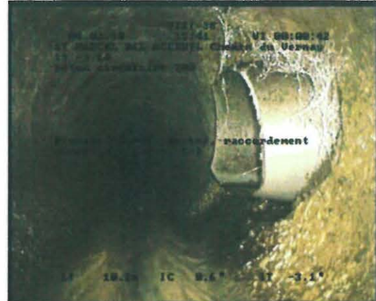
Photo: 0000074.JPG, 00:00:41 10,6m, Piquage direct, buriné, raccordement ouvert à 3 h., -, (-)
