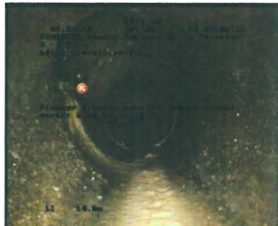
Photo: 0000018.JPG, 00:02:22 14,4m, Piquage direct, carotté, raccordement ouvert à 10 h., -, (-)
