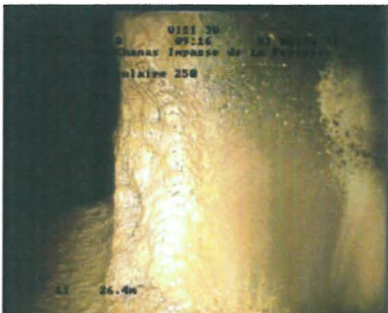
Photo: 0000036.JPG, 00:06:19 26,41m, Dépôts adhérents, concrétions de 12 à 12 h. -
