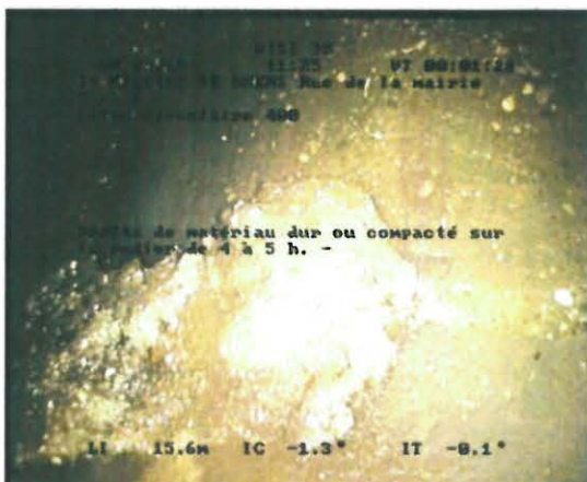
Photo: 0000031.JPG, 00:01:28 15,68m, Dépôts de matériau dur ou compacté sur le radier de 4 à 5 h. -
