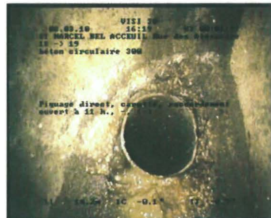
Photo: 0000089.JPG, 00:01:55 14,24m, Piquage direct, carotté, raccordement ouvert à 11 h., -, (-)
