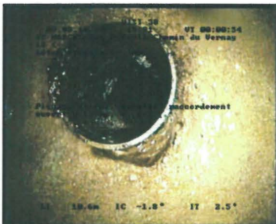
Photo: 0000063.JPG, 00:00:54 10,67m, Piquage direct, carotté, raccordement ouvert à 12 h., -, (-)
