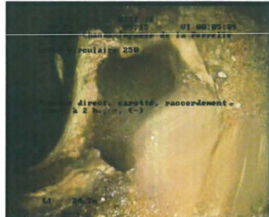
Photo: 0000031.JPG, 00:05:10 24,75m, Piquage direct, carotté, raccordement ouvert à 2 h., -, (-)
