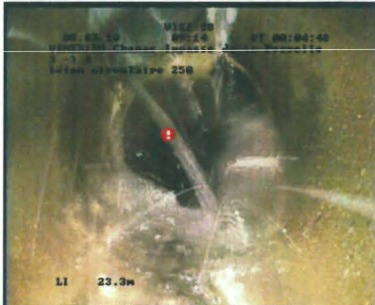
Photo: 0000030.JPG, 00:04:26 23,7m, Écoulement dans canalisation entrante, clair, aucun mauvais raccordement observé à 11 h., -
