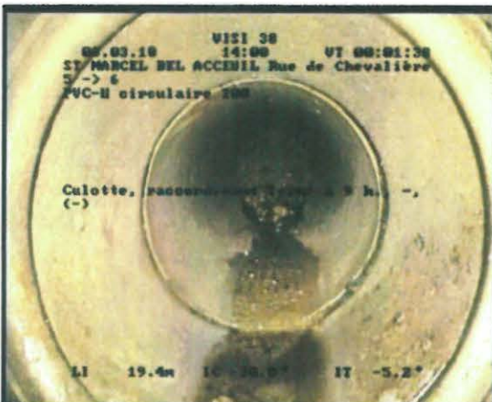
Photo: 0000025.JPG, 00:01:24 19,48m, Culotte, raccordement fermé à 9 h., -, (-)
