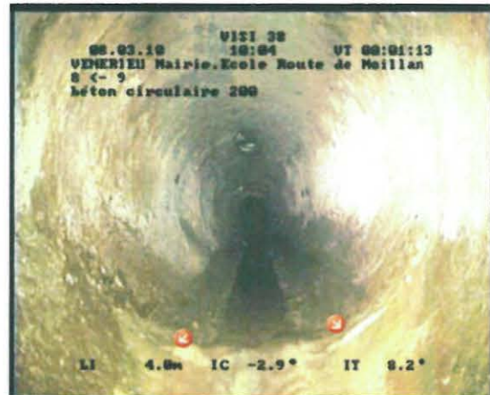
Photo: 0000054.JPG, 00:01:04 4,24m, Infiltration, écoulement continu, de 4 à 8 h., joint
