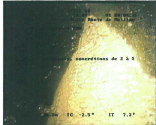
Photo: 0000062.JPG, 00:04:35 21,52m, Dépôts adhérents, concrétions de 2 à 5 h. -
