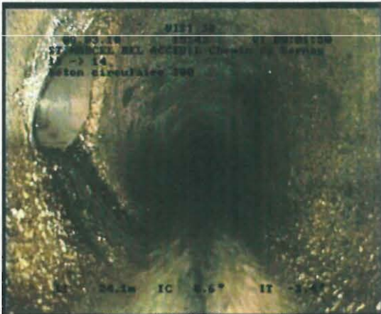
Photo: 0000077.JPG, 00:01:35 24,56m, Piquage direct, carotté, raccordement ouvert à 10 h., -, (-)
