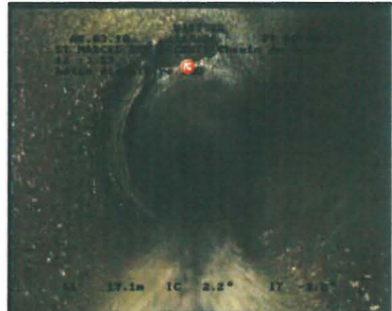
Photo: 0000071.JPG, 00:00:43 17,59m, Piquage direct, carotté, raccordement ouvert à 11 h., -, (-)
