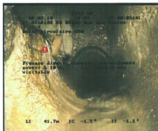
Photo: 0000022.JPG, 00:03:39 41,83m, Piquage direct, carotté, raccordement ouvert à 10 h., -, (-)
