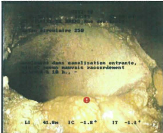
Photo: 0000023.JPG, 00:03:59 41,83m, Écoulement dans canalisation entrante, clair, aucun mauvais raccordement observé à 10 h., -
