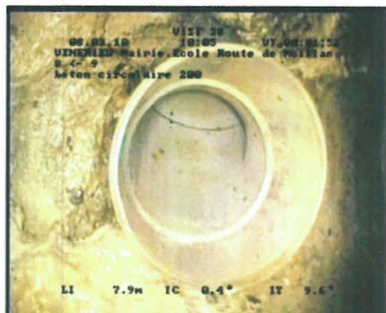
Photo: 0000056.JPG, 00:01:41 7,96m, Piquage direct, carotté, raccordement ouvert à 11 h., -, (-)
