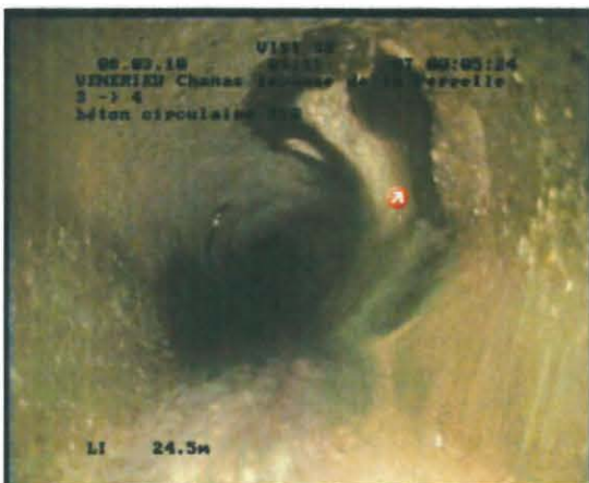
Photo: 0000032.JPG, 00:05:10 24,75m, Piquage direct, carotté, raccordement ouvert à 2 h., -, (-)
