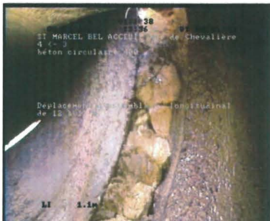
Photo: 0000019.JPG, 00:01:04 1,19m, Déplacement d'assemblage, longitudinal de 12 à 12 h. -
