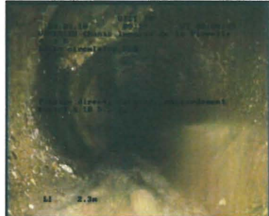
Photo: 0000039.JPG, 00:00:44 2,64m, Piquage direct, carotté, raccordement ouvert à 10 h., -, (-)
