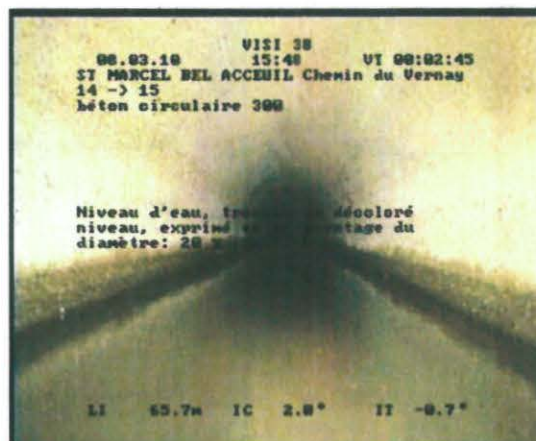
Photo: 0000081.JPG, 00:02:44 65,71m, Niveau d'eau, trouble ou décoloré niveau, exprimé en pourcentage du diamètre: 20 %
