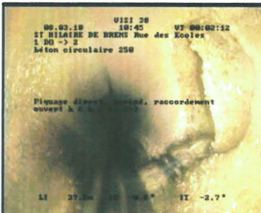
Photo: 0000003.JPG, 00:02:12 37,54m, Piquage direct, buriné, raccordement ouvert à 2 h., -, (-)
