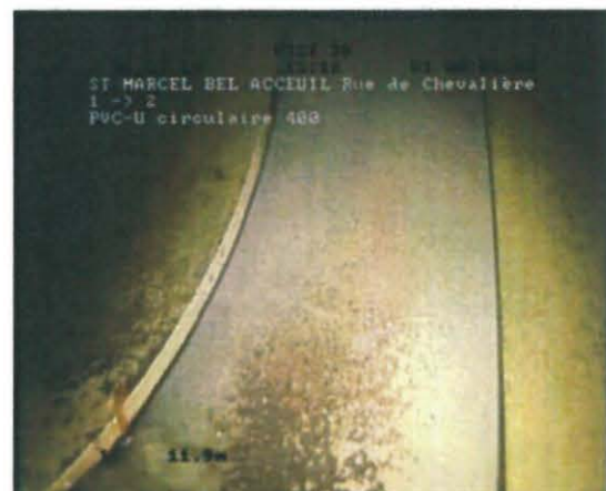
Photo: 0000008.JPG, 00:03:25 11,94m, Déplacement d'assemblage, longitudinal de 12 à 12 h., -
