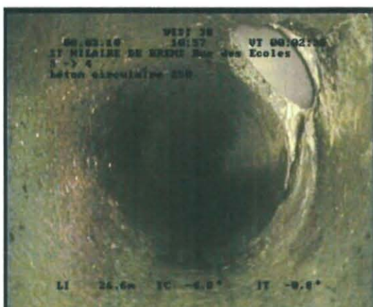
Photo: 0000021.JPG, 00:02:27 26,97m, Piquage direct, carotté, raccordement ouvert à 1 h., -, (-)
