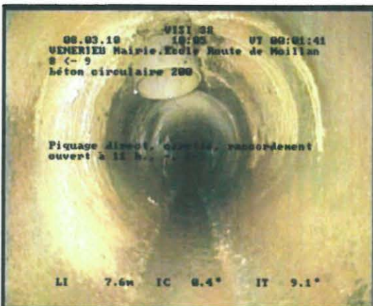
Photo: 0000055.JPG, 00:01:41 7,96m, Piquage direct, carotté, raccordement ouvert à 11 h., -, (-)
