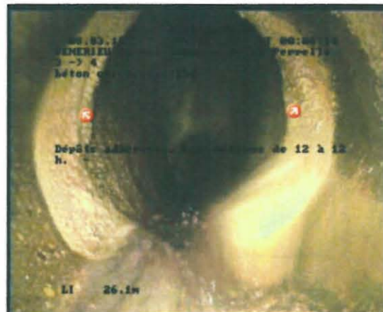
Photo: 0000035.JPG, 00:06:19 26,41m, Dépôts adhérents, concrétions de 12 à 12 h. -
