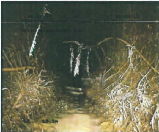
Photo: 0000009.JPG, 00:02:47 12,15m, Ensemble complexe de racines de 12 à 12 h. -, Début
