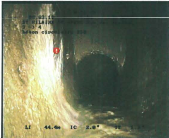
Photo: 0000027.JPG, 00:04:57 44,84m, Écoulement dans canalisation entrante, clair, aucun mauvais raccordement observé à 10 h., -
