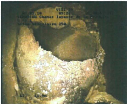
Photo: 0000046.JPG, 00:01:28 11,97m, Piquage direct, carotté, raccordement ouvert à 11 h., -, (-)
