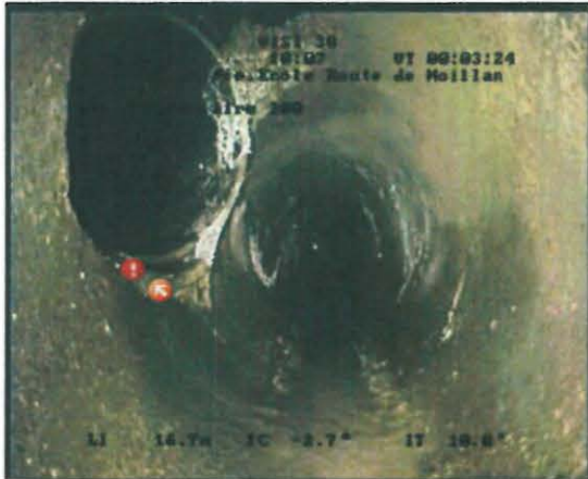
Photo: 0000061.JPG, 00:03:12 16,99m, Écoulement dans canalisation entrante, clair, aucun mauvais raccordement observé à 10 h., -
