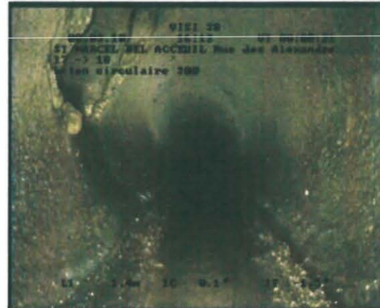
Photo: 0000084.JPG, 00:00:11 1,47m, Piquage direct, carotté, raccordement ouvert à 11 h., -, (-)
