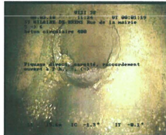
Photo: 0000030.JPG, 00:01:19 15,68m, Piquage direct, carotté, raccordement ouvert à 1 h., - (-)
