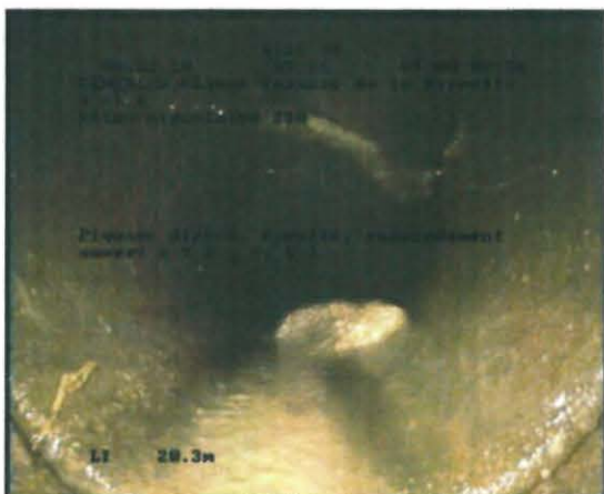
Photo: 0000024.JPG, 00:02:27 20,72m, Piquage direct, carotté, raccordement ouvert à 1 h., -, (-)
