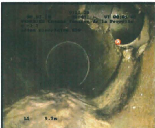
Photo: 0000050.JPG, 00:00:52 9,86m, Piquage direct, carotté, raccordement ouvert à 2 h., -, (-)
