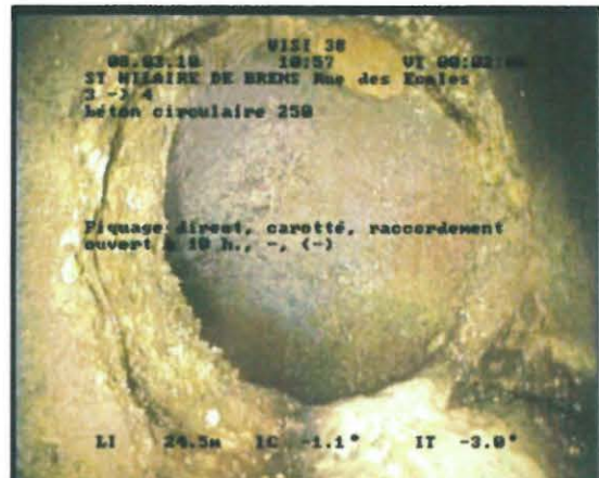
Photo: 0000018.JPG, 00:02:00 24,56m, Piquage direct, carotté, raccordement ouvert à 10 h., -, (-)
