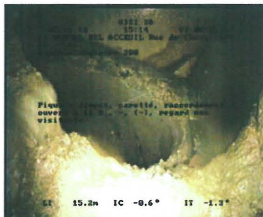
Photo: 0000052.JPG, 00:01:13 15,26m, Piquage direct, carotté, raccordement ouvert à 11 h., -, (-)
