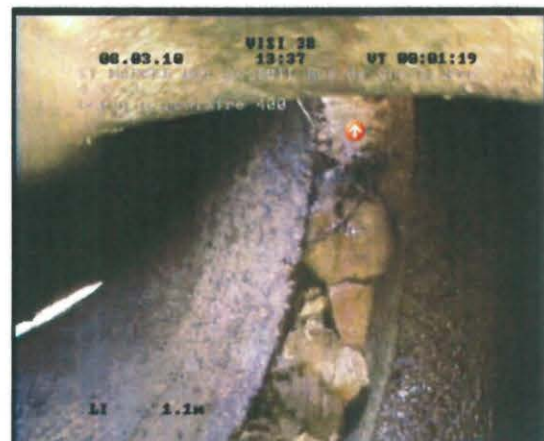
Photo: 0000020.JPG, 00:01:09 1,19m, Un vide hors de la conduite est visible par le trou laissé par le défaut
