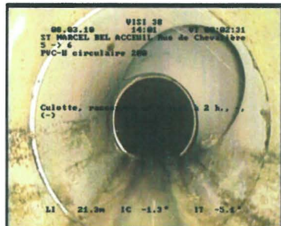
Photo: 0000026.JPG, 00:02:28 21,71m, Culotte, raccordement ouvert à 2 h., -, (-)
