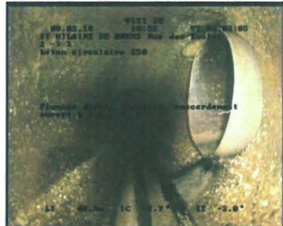
Photo: 0000012.JPG, 00:03:04 48,63m, Piquage direct, carotté, raccordement ouvert à 3 h., -, (-)
