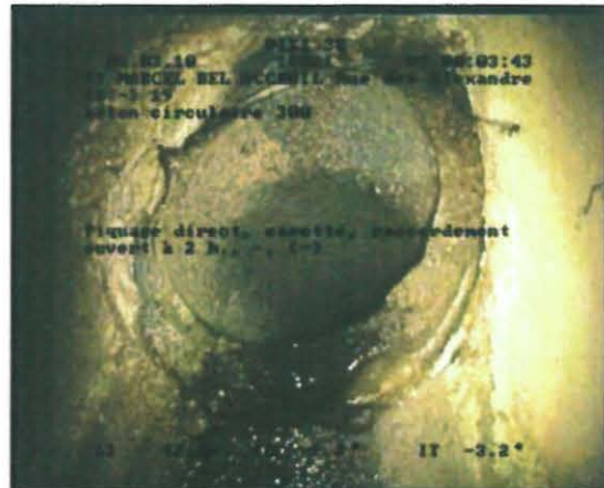
Photo: 0000091.JPG, 00:03:44 42,44m, Piquage direct, carotté, raccordement ouvert à 2 h., -, (-)
