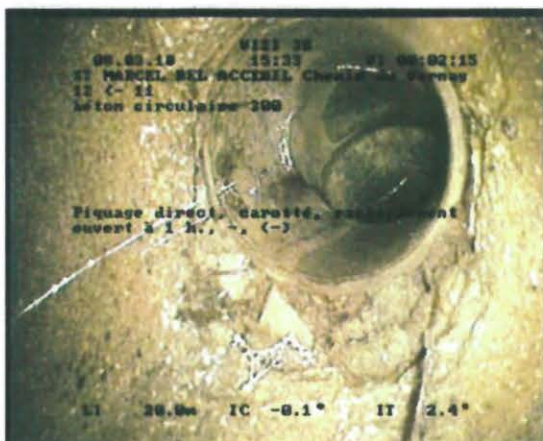
Photo: 0000067.JPG, 00:02:15 20m, Piquage direct, carotté, raccordement ouvert à 1 h., -, (-)
