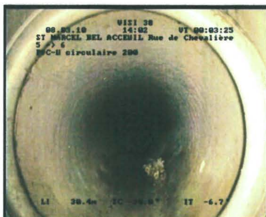
Photo: 0000029.JPG, 00:03:15 30,47m, Culotte, raccordement ouvert à 10 h., -, (-)
