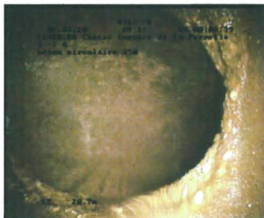
Photo: 0000025.JPG, 00:02:27 20,72m, Piquage direct, carotté, raccordement ouvert à 1 h., -, (-)
