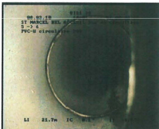
Photo: 0000027.JPG, 00:02:28 21,71m, Culotte, raccordement ouvert à 2 h., -, (-)
