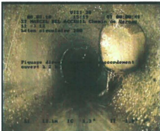
Photo: 0000058.JPG, 00:00:48 12,7m, Piquage direct, carotté, raccordement ouvert à 2 h., -, (-)
