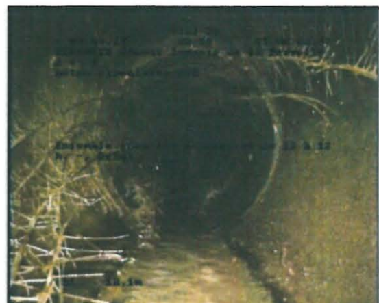
Photo: 0000008.JPG, 00:02:47 12,15m, Ensemble complexe de racines de 12 à 12 h., - Début
