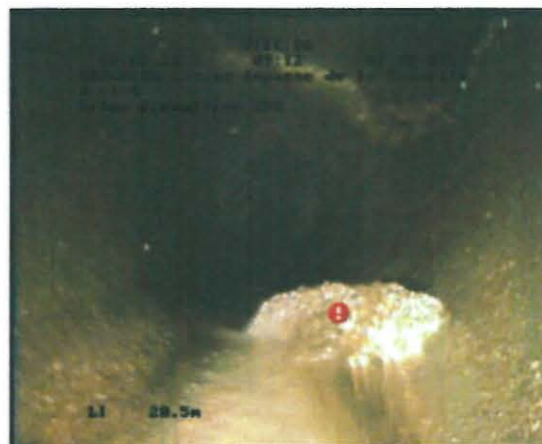
Photo: 0000027.JPG, 00:03:01 20,72m, Dépôts de matériau dur ou compacté sur le radier de 4 à 6 h. -
