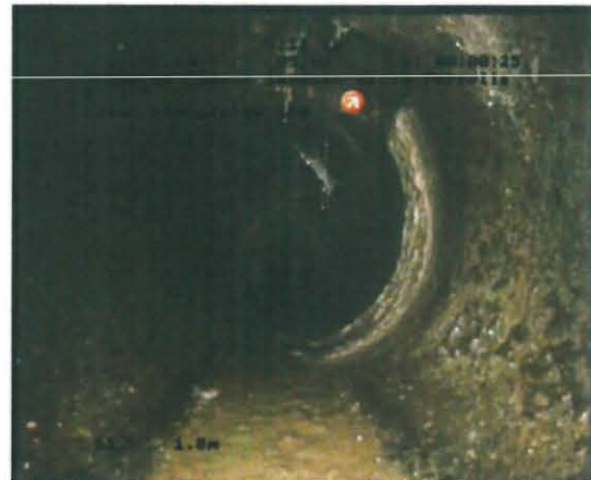
Photo: 0000012.JPG, 00:00:12 2,08m, Piquage direct, carotté, raccordement ouvert à 1 h., -, (-)
