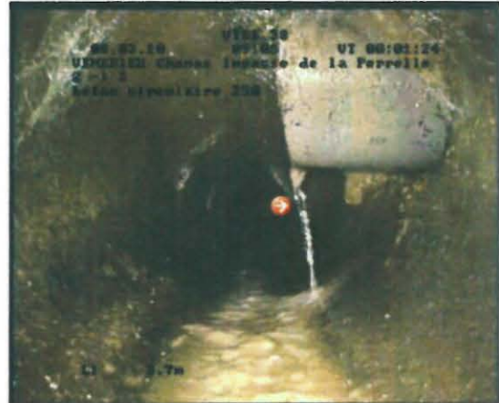
Photo: 0000016.JPG, 00:01:07 4m, Écoulement dans canalisation entrante, clair, aucun mauvais raccordement observé -, -
