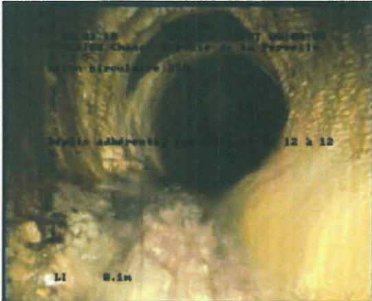
Photo: 0000038.JPG, 00:00:07 0,13m, Dépôts adhérents, concrétions de 12 à 12 h. -
