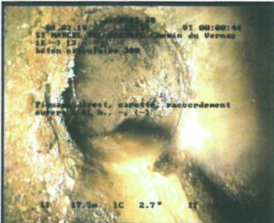
Photo: 0000070.JPG, 00:00:43 17,59m, Piquage direct, carotté, raccordement ouvert à 11 h., -, (-)
