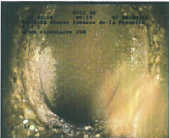
Photo: 0000040.JPG, 00:00:44 2,64m, Piquage direct, carotté, raccordement ouvert à 10 h., -, (-)
