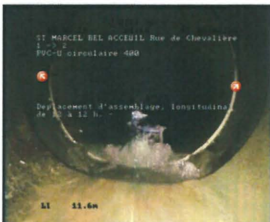
Photo: 0000007.JPG, 00:03:25 11,94m, Déplacement d'assemblage, longitudinal de 12 à 12 h., -
