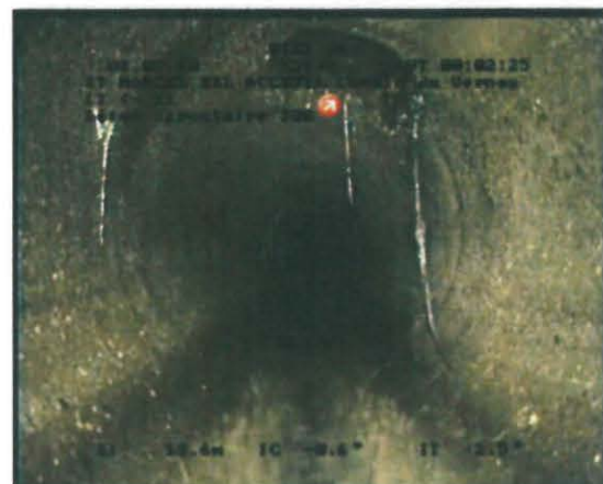
Photo: 0000068.JPG, 00:02:15 20m, Piquage direct, carotté, raccordement ouvert à 1 h., -, (-)
