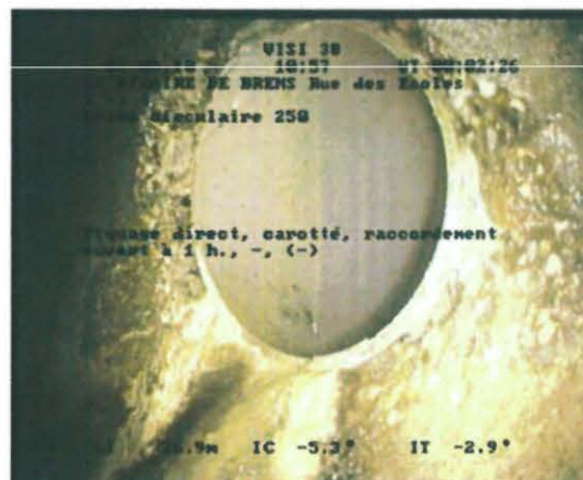
Photo: 0000020.JPG, 00:02:27 26,97m, Piquage direct, carotté, raccordement ouvert à 1 h., -, (-)
