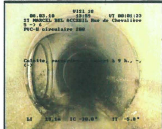
Photo: 0000024.JPG, 00:01:24 19,48m, Culotte, raccordement fermé à 9 h., -, (-)
