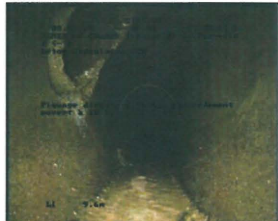
Photo: 0000006.JPG, 00:01:35 9,9m, Piquage direct, carotté, raccordement ouvert à 10 h., - (-)
