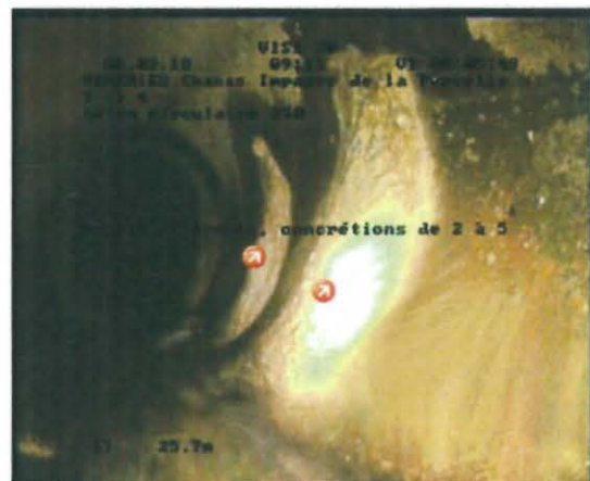
Photo: 0000033.JPG, 00:05:48 25,94m, Dépôts adhérents, concrétions de 2 à 5 h. -
