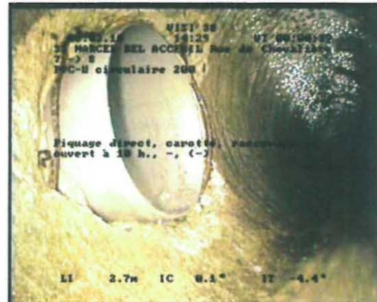
Photo: 0000037.JPG, 00:00:38 2,78m, Piquage direct, carotté, raccordement ouvert à 10 h., -, (-)
