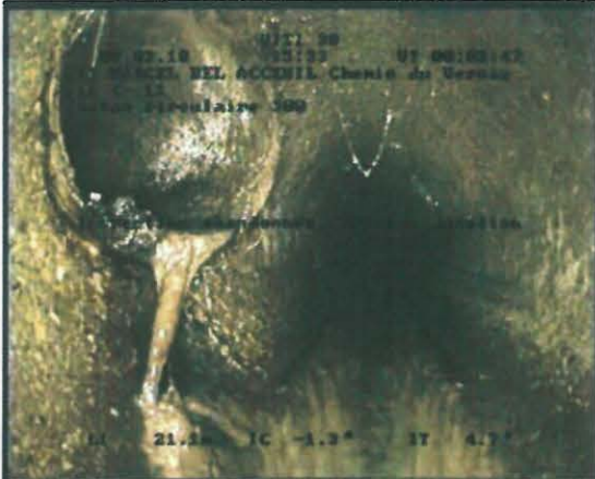
Photo: 0000069.JPG, 00:02:44 21,51m, Inspection abandonnée, autre : jonction
