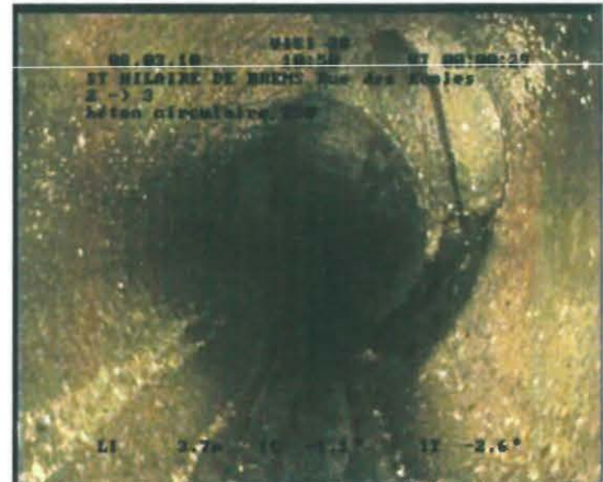
Photo: 0000008.JPG, 00:00:21 4,08m, Piquage direct, carotté, raccordement ouvert à 2 h., -, (-)
