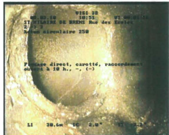
Photo: 0000010.JPG, 00:01:57 30,62m, Piquage direct, carotté, raccordement ouvert à 10 h., -, (-)
