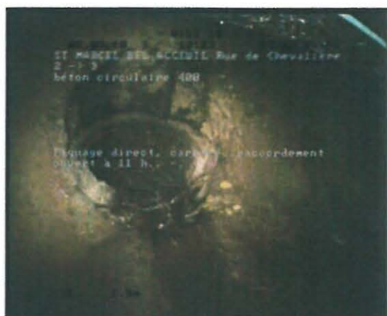
Photo: 0000013.JPG, 00:00:00 1,99m, Piquage direct, carotté, raccordement ouvert à 11 h. -, (-)
