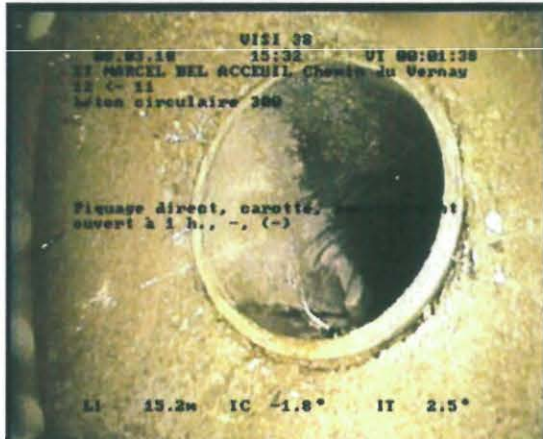
Photo: 0000065.JPG, 00:01:38 15,25m, Piquage direct, carotté, raccordement ouvert à 1 h., -, (-)
