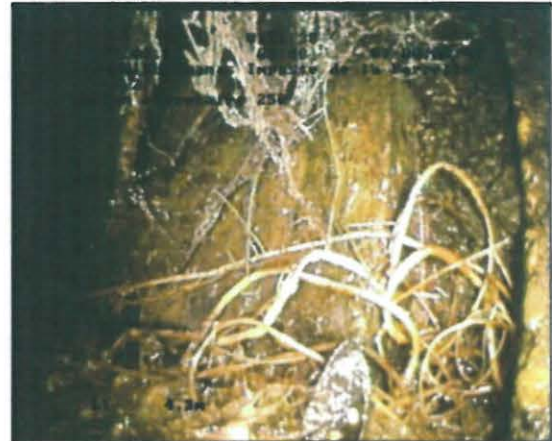
Photo: 0000002.JPG, 00:00:35 4,37m, Radicelles de 12 à 12 h. -, joint
