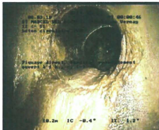
Photo: 0000062.JPG, 00:00:45 10,24m, Piquage direct, carotté, raccordement ouvert à 1 h., -, (-)
