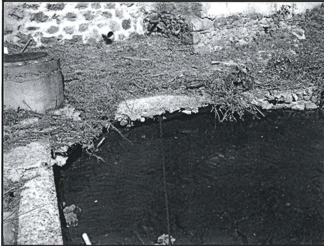
Jonction de deux tuyaux visible et en partie immergée
