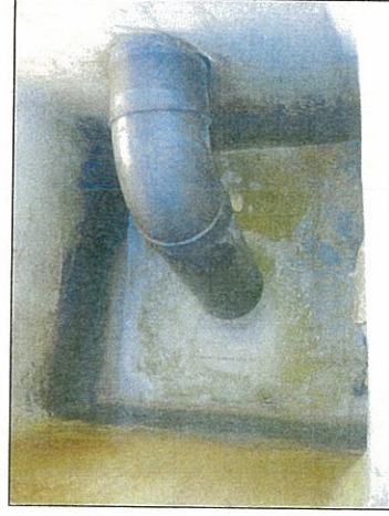
7. Recirculation des boues du décanteur vers le poste de relèvement des eaux usées
