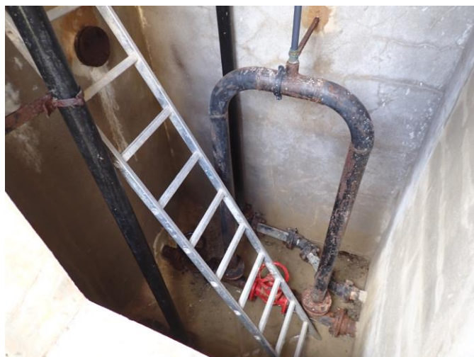
Vue intérieure de la chambre de vannes
