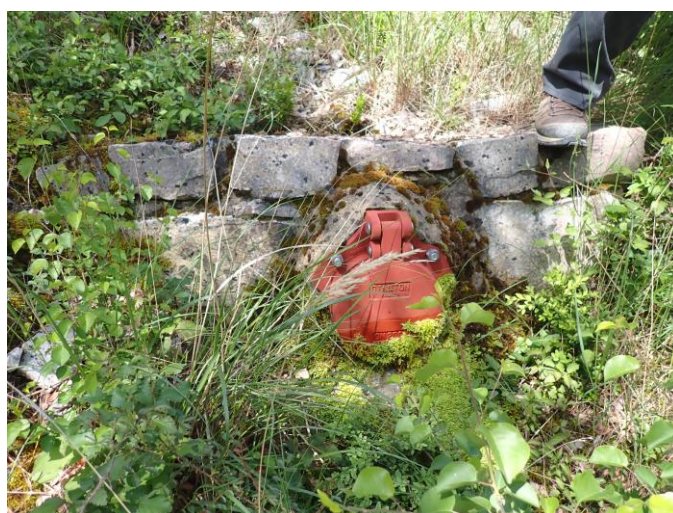
Clapet anti-retour à l'exutoire de la vidange/trop-plein
