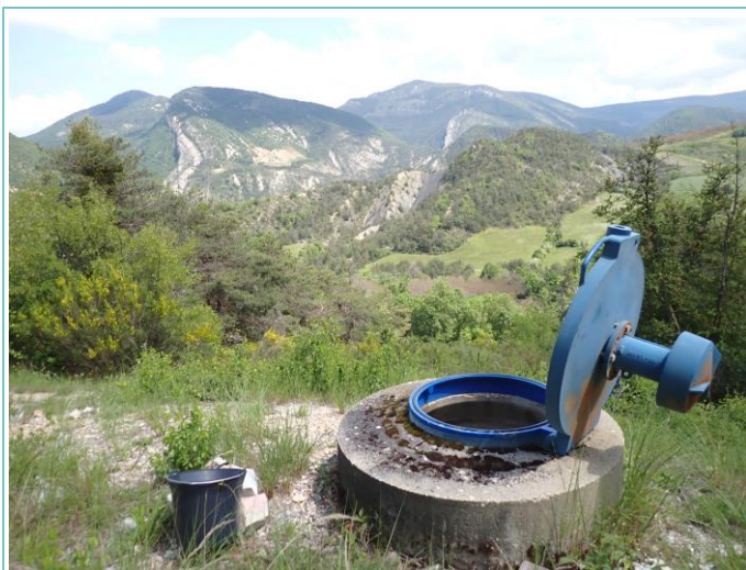
Regard d'accès à la chambre de captage
