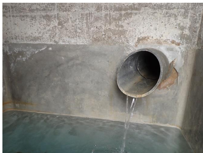
Arrivée des eaux drainées
