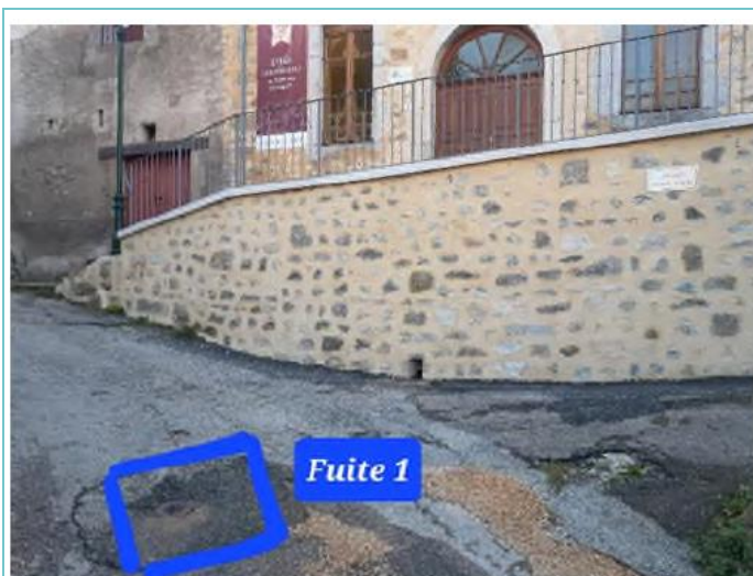
Localisation de la fuite F1
