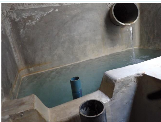
Bassin de réception-décantation
