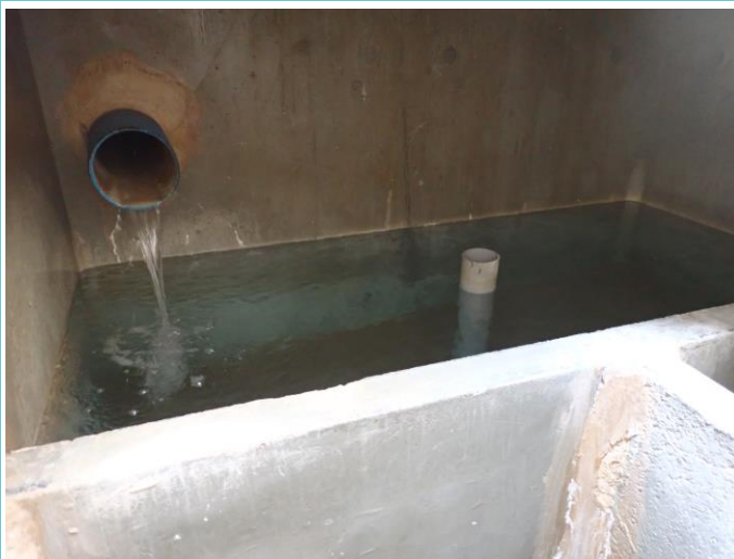
Bassin de réception-décantation
