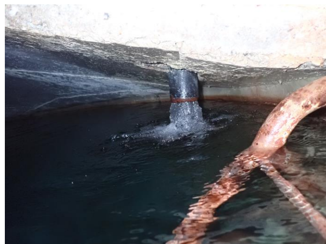
Arrivée du réseau d'adduction
