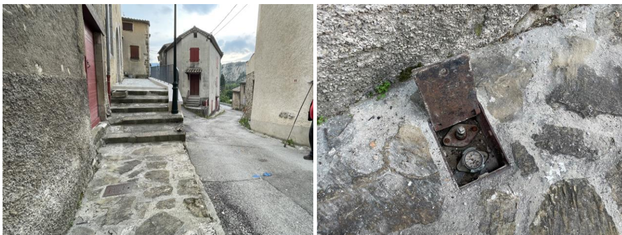
Illustration 5 : Bouche incendie - Réseau AEP de La Charce
