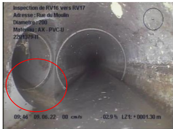
Figure 3 : Illustration d'une infiltration d'ECPP par une canalisation de branchement à gauche – Rue Principale
