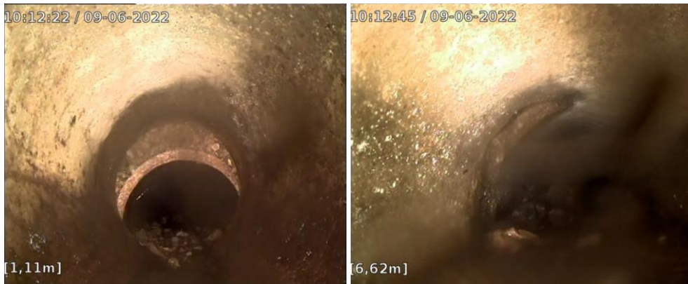
Figure 7 : Illustration de la canalisation de branchement en amiante-ciment - Rue principale
