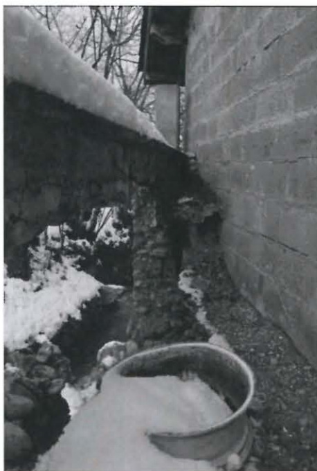
Mur effondré dans le cours d'eau.
