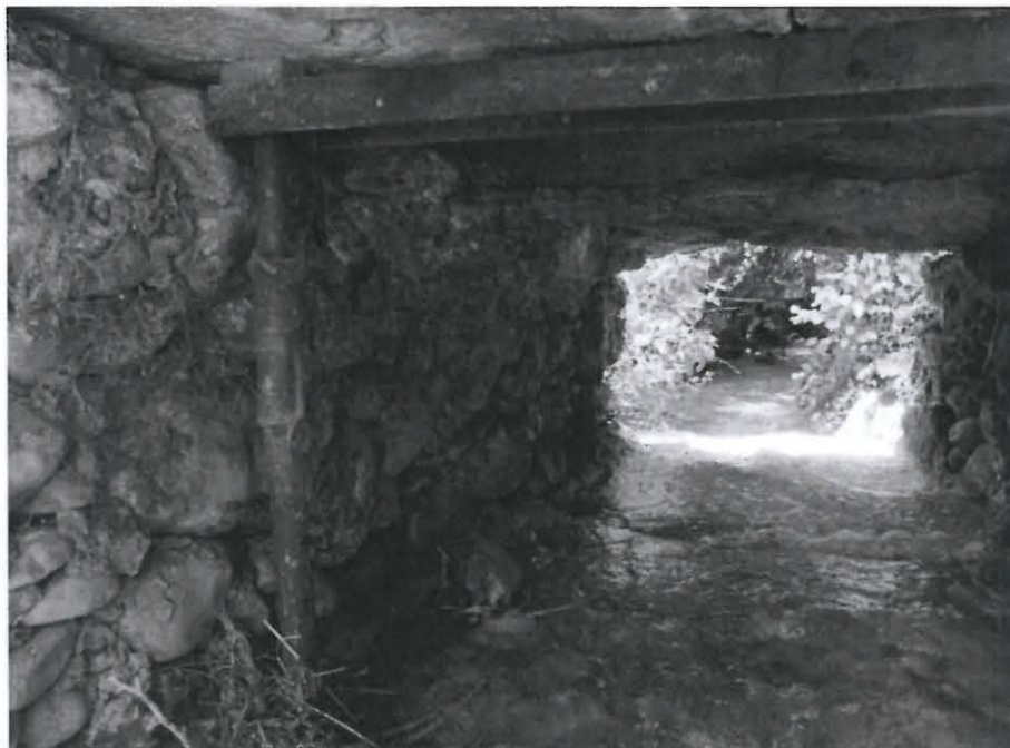
Pont du Crozarieu à refaire
