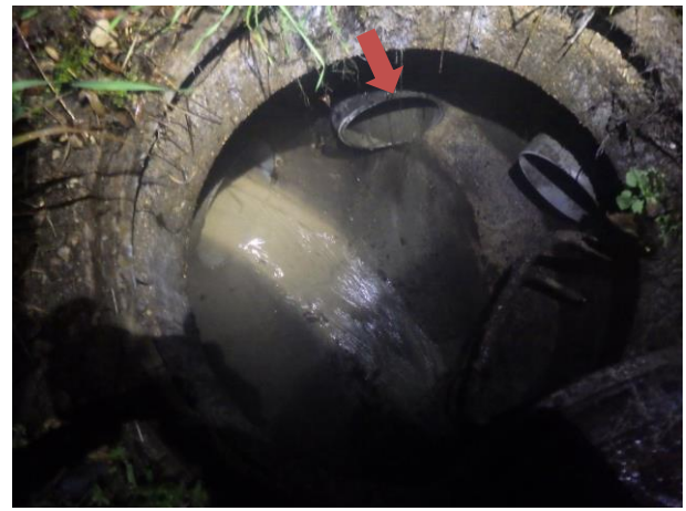
Absence d'arrivée d'eaux en provenance de l'antenne du bassin d'orage de la rue des Viaducs
