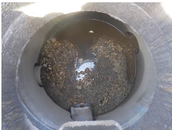
Apport de cailloux et stagnation des effluents – Croisement de la rue du Canton et de la rue de Cueille – ID 657
