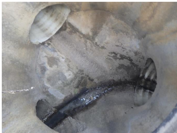
Rue Georges Sand – ID 1096 – Traces d'eaux usées domestiques dans un regard de visite pluvial
