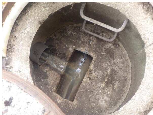
Fissure au niveau du radier – Chemin de Trechelle – ID 673
