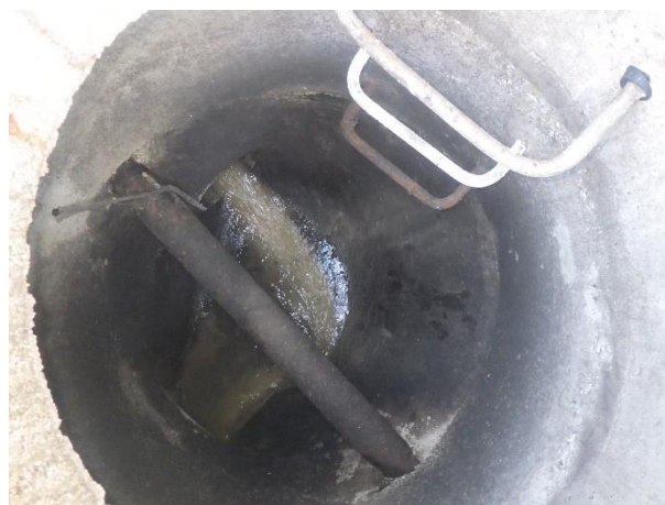
Canalisation d'eau potable traversant le regard unitaire – ID 452 – rue de la Vignette
