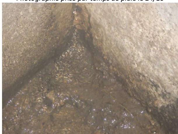
DO n°14 – RD 470 – Ecoulement d'eaux claires au niveau de la cheminée
