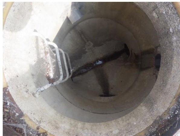
Impasse des Montagnards - ID 914 – Effluent rosâtre dans un regard de visite pluvial
