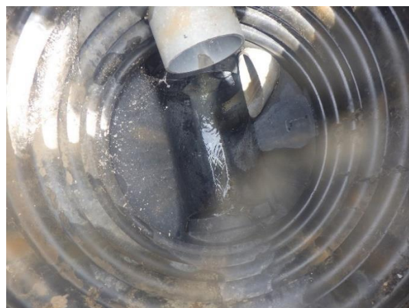
Rue François Bourdeau - ID 833 – Eaux usées domestiques dans un regard de visite pluvial
