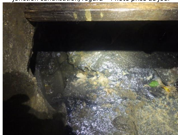
Regard n°206 – Chemin des Luges – Radier partiellement effondré
