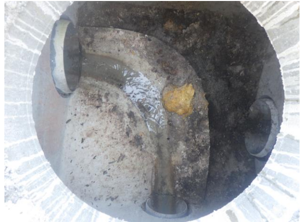
Déversoir d'orage n°17 – Forte tendance à l'encrassement
