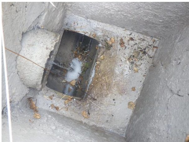
Effluent blanchâtre en provenance du branchement de l'entreprise Meynier – ID 288
