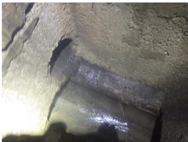
Regard n°206 – Chemin des Luges – Fissures au niveau du radier
