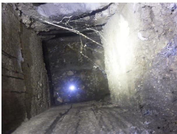
Regard n°754 – Chemin de la Sarre – Radier effondré
