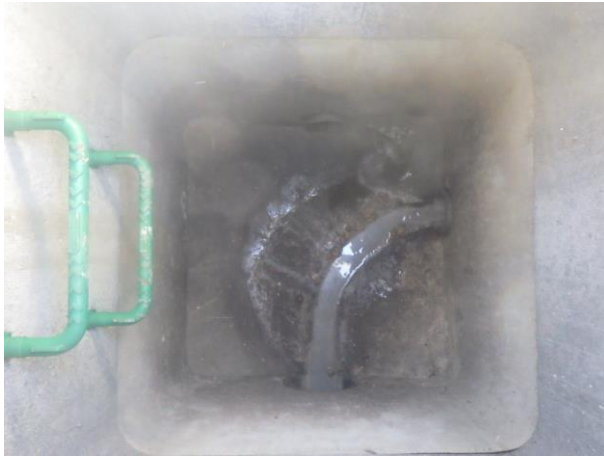
Déversoir d'orage n°5 avec léger déversement par temps sec
