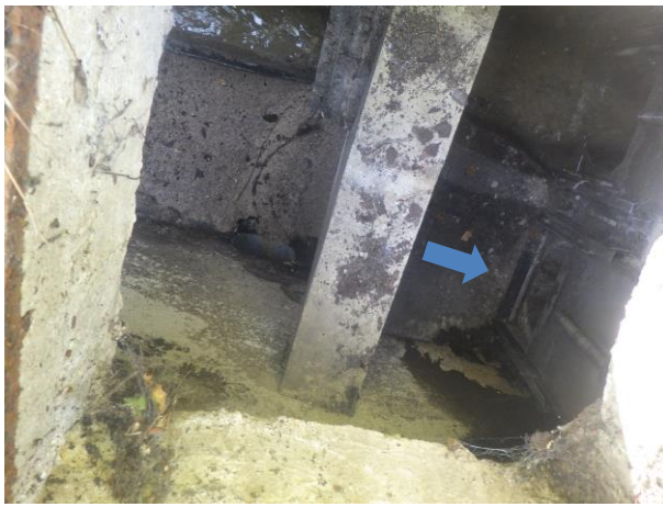
Bypass du bassin d'orage
