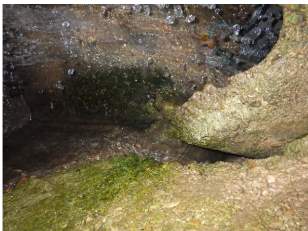
Regard n°752 – Chemin des Arrivoires – Ecoulement d'eaux claires au niveau de la jonction canalisation/regard
