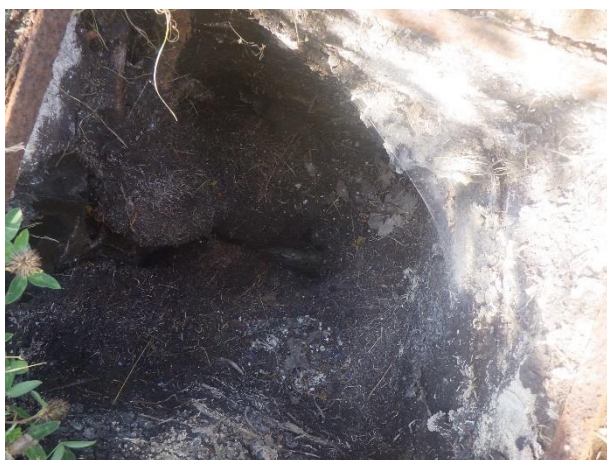
Intrusions de racines dans un regard de visite - Route des Viaducs – ID 455
