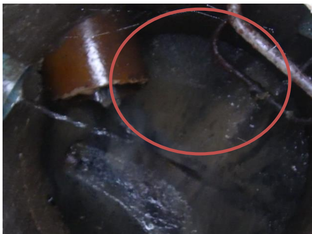
Regard n°43 – Rue de Bellevue – Ecoulement d'eaux claires au niveau de la jonction radier/cheminée – Photographie prise par temps de pluie le 24/10
