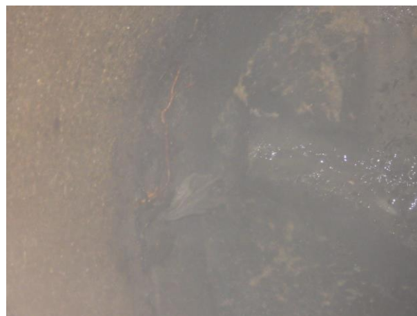
Regard n°23 – Rue de Tré la Croix – Suintement au niveau des racines
