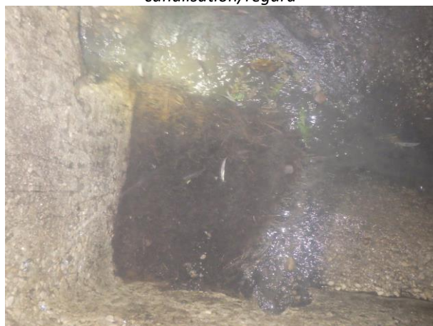
Regard n°80 – Escalier entre la rue de Bellevue et la rue de Melay – Suintement au niveau des racines
