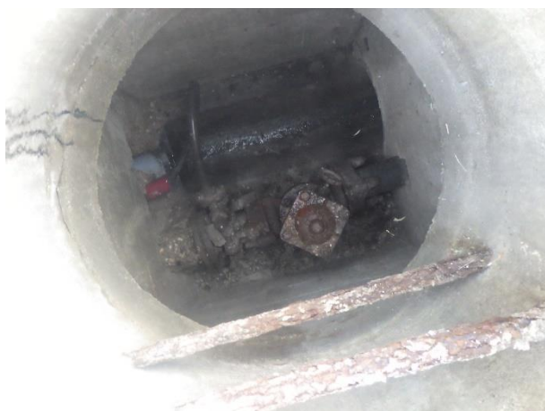
Canalisation d'eau potable traversant le regard unitaire – ID 761 – rue de la Vignette
