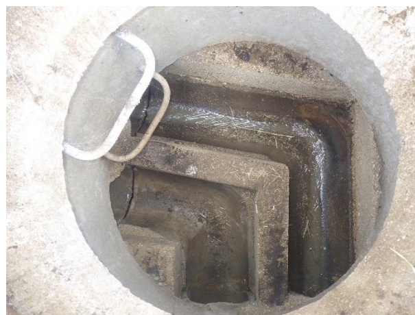
Exfiltration au niveau de la jonction regard/canalisation – Rue du Monnet - ID 297
