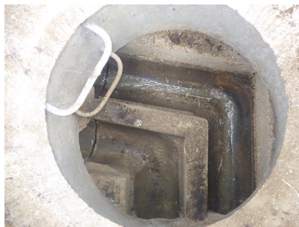
Regard n°295 – Le Monnet – Exfiltration au niveau de la jonction canalisation/regard – Photo prise de jour
