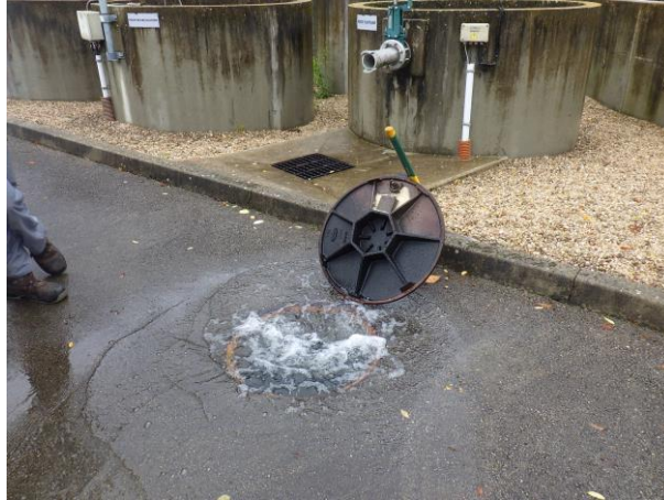
Débordement au niveau du tampon en sortie de clarificateur – 24/10/2023
