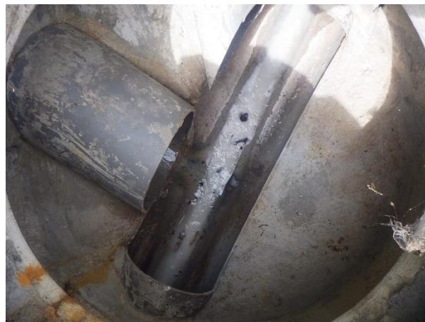
Effluent blanchâtre en provenance du branchement de l'entreprise Meynier – ID 269
