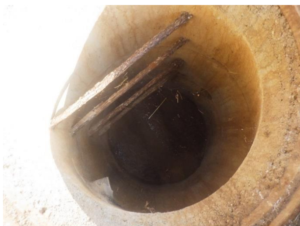
Rue de Fourger – ID 514 – Traces d'eaux usées dans les réseaux unitaires et pluviaux malgré la mise en séparatif
