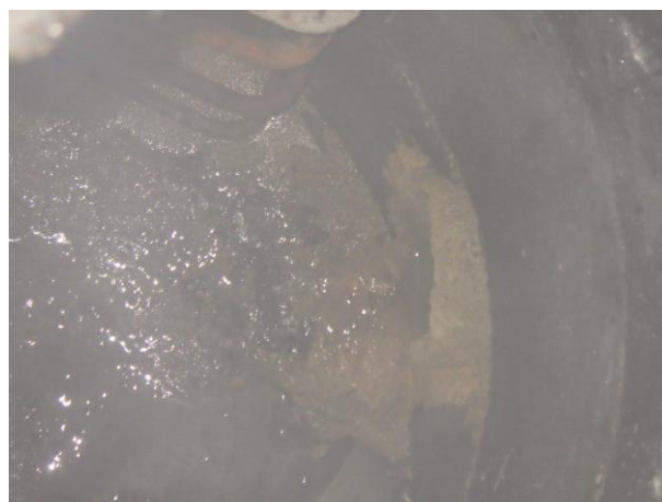
Regard n°232 – Route du Pèlerin – Ecoulement d'eaux claires au niveau de la cheminée
