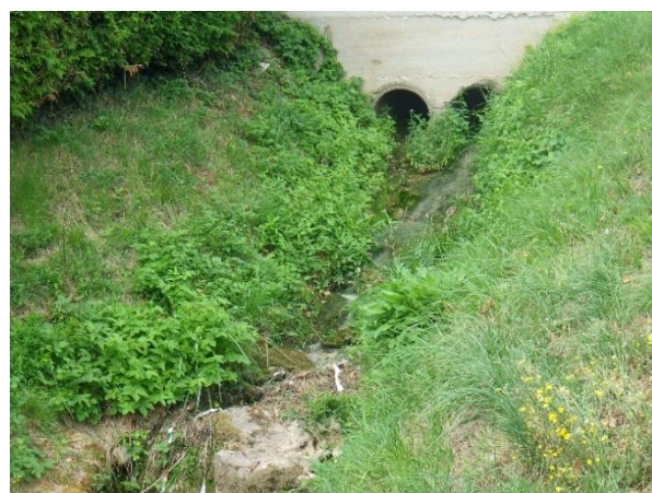
Rue de la Fortuné - Traces d'eaux usées au niveau de l'exutoire d'un des réseaux pluviaux
