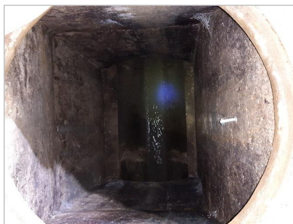
Figure 79 : Transit d'ECP dans les réseaux de Garanche
