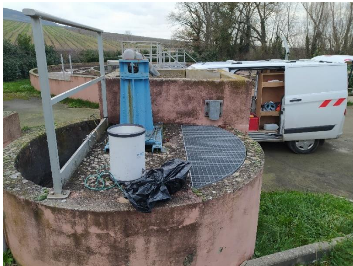
Figure 47 : Pluviomètre installé sur la station d'épuration de Garanche
