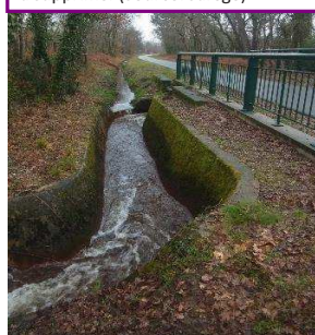
"S" bétonné au niveau du Massurat à supprimer (Source: Safege)
