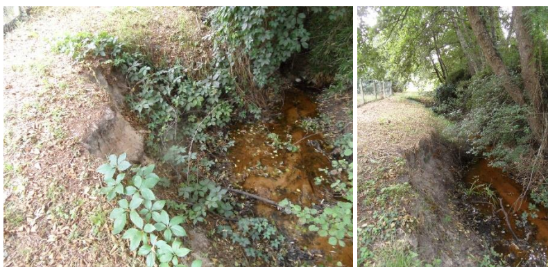
Figure 30 : Points d'érosion observés
