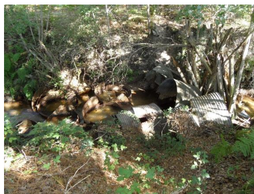
Figure 6 : Vestiges d'ouvrage bloquant la totalité de la section d'écoulement du cours d'eau
