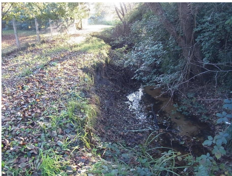
Figure 26 : Le Massurat tronçon n° 3 - érosion
