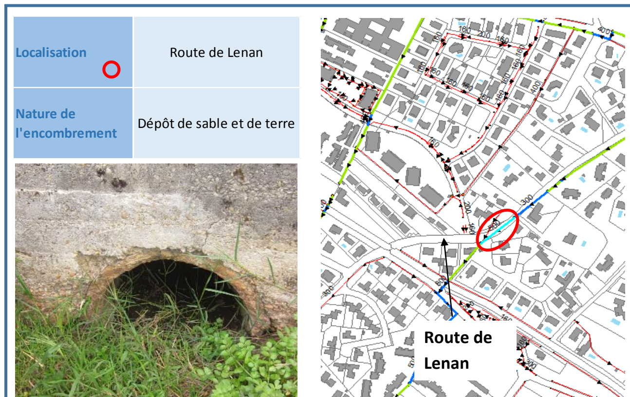
Figure 6-5 : Exemple de canalisations obstruées constatées
