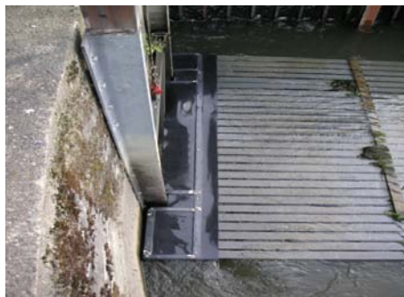
Photo 5 : Grille de tranquillisation avec bavette (en position hors d'eau)
