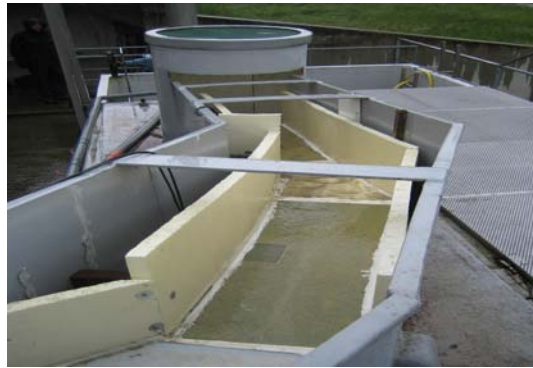
Photo 3 : Dispositif de détection du piège de Pointis
