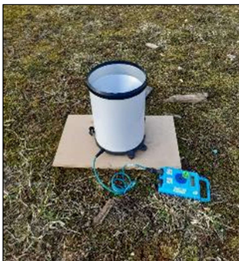
Figure 3 : Pluviomètre installé aux ateliers municipaux
