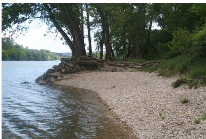
Erosion derrière enrochement de berge à l'aval du site.
