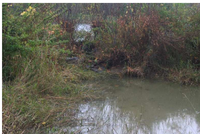
Brèche au droit du casier n°3.
