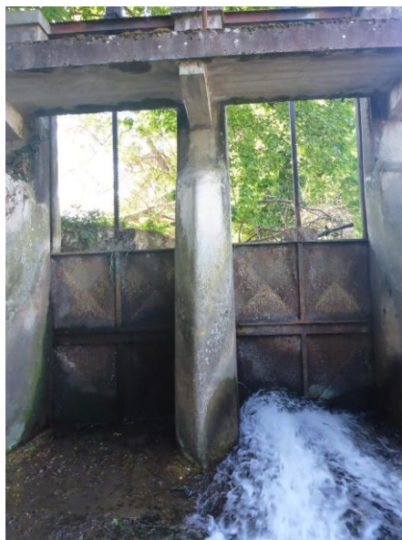
Vannes de vidange
