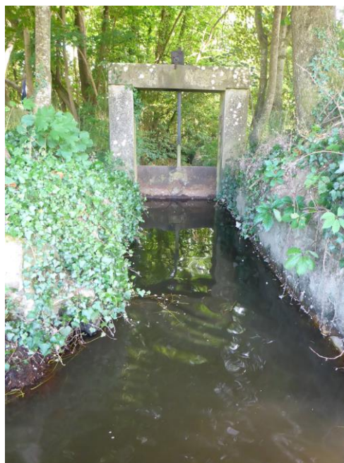
Vanne de décharge sur le bief
