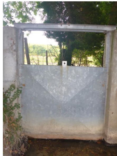
Vanne du bief
