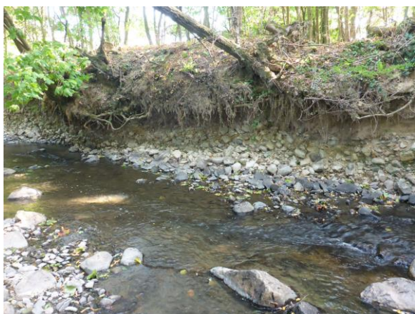
Érosion de berge à l'aval du seuil
