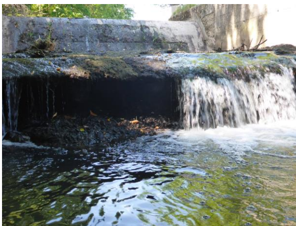
Affouillement du radier
