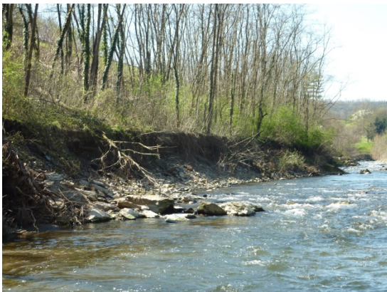
Anse d'érosion en rive droite aval
