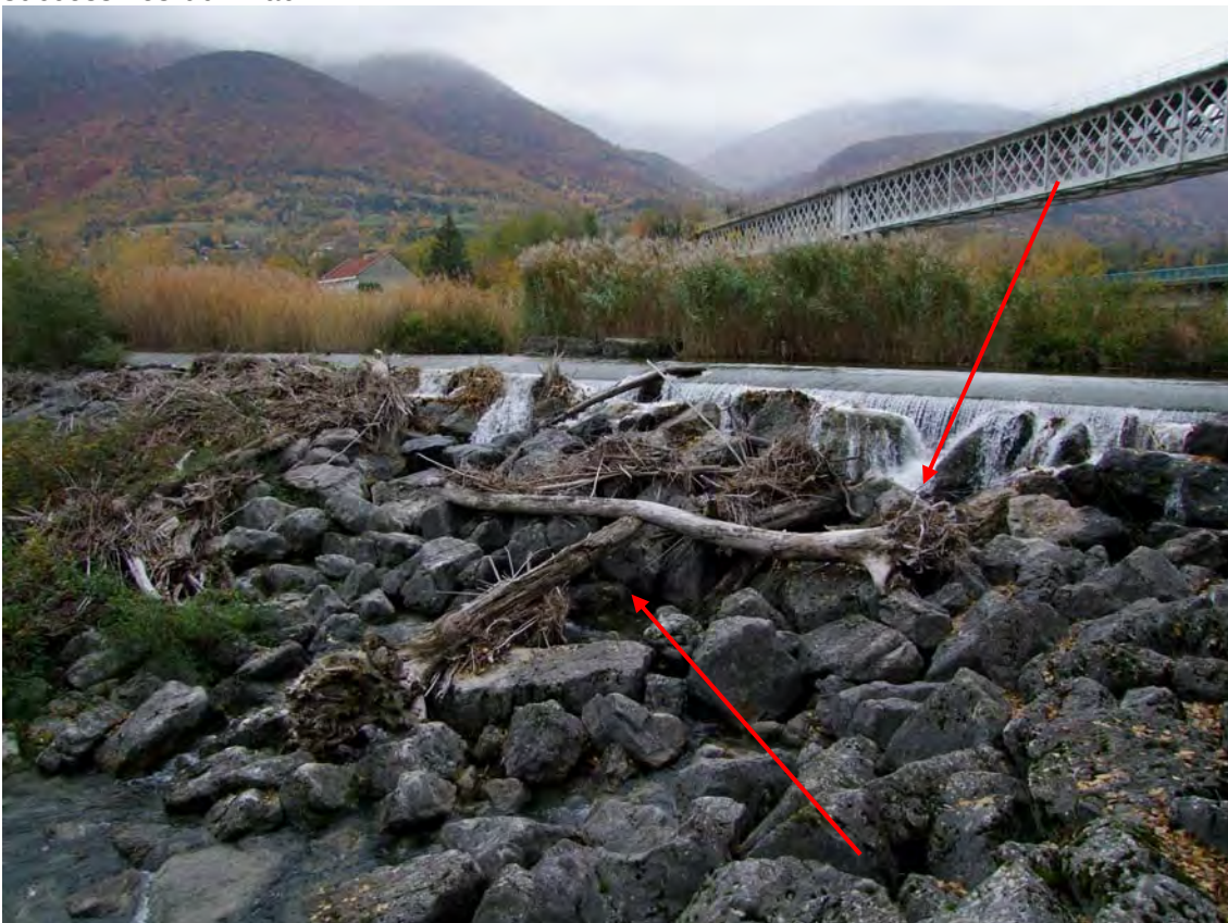
Lacunes ponctuelles d'enrochement
