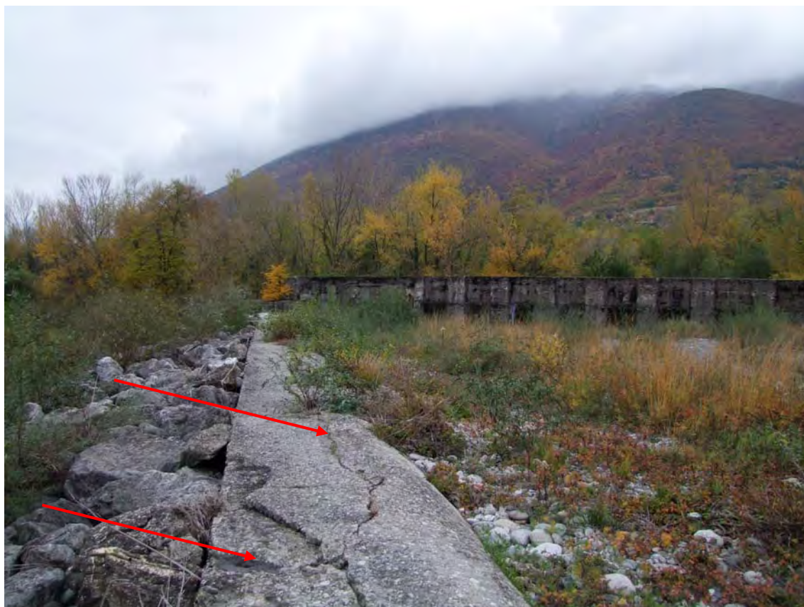
Crête béton dégradée
