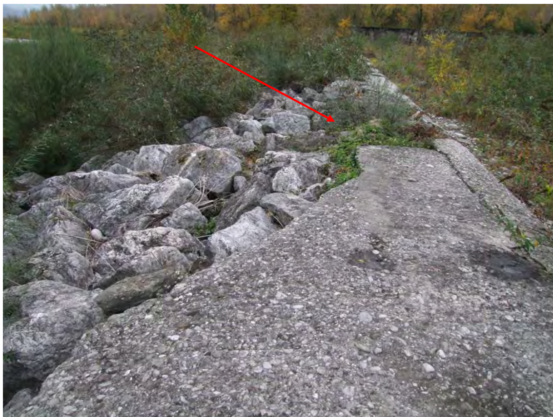
Crête béton absente
