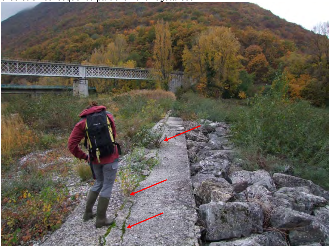
Crête béton fissurée et végétalisée
