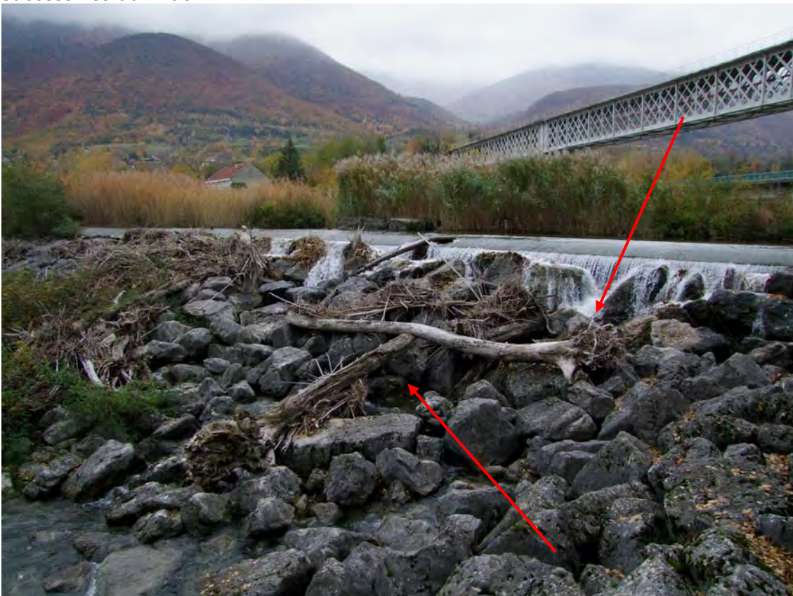
Lacunes ponctuelles d'enrochement
