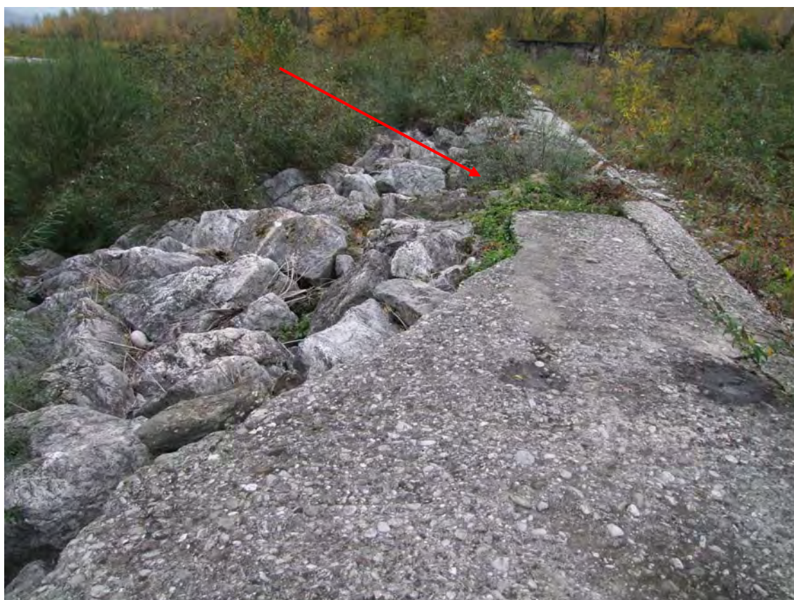
Crête béton absente
