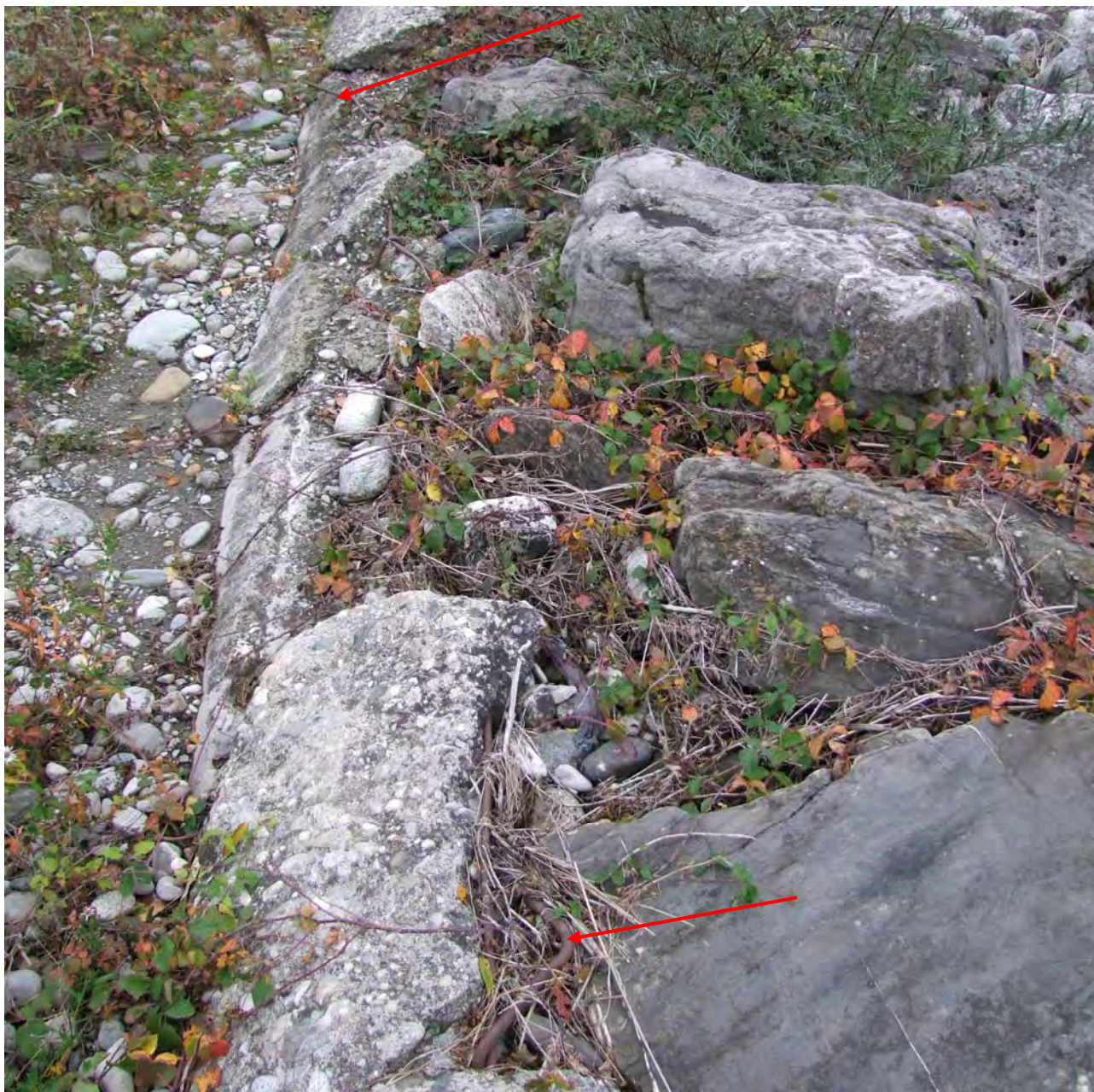
Crête béton absente, laissant apparaître des aciers de structure
