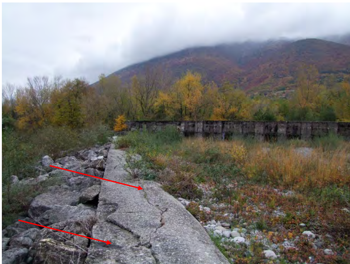
Crête béton dégradée
