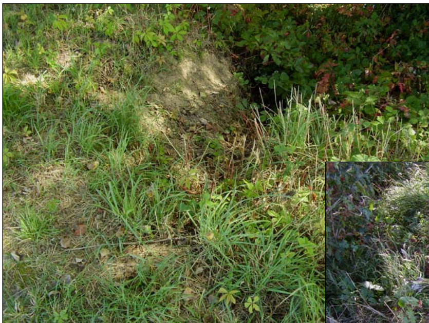
SEREINE – rive droite – Tronçon S05d désordres dans la digue : échancrures ci-contre trous ci-dessous
