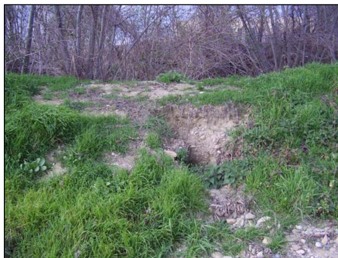
SEREINE – rive gauche – Tronçon S06g point bas crête et érosion
