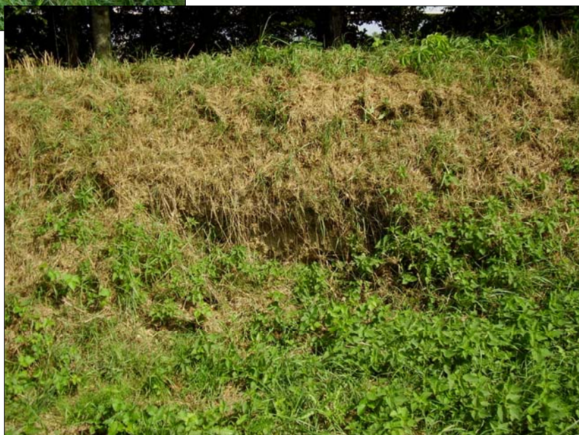
SEREINE – rive droite – Tronçon S05d désordres dans la digue : marche d'escalier avec terre viable en pied de talus
