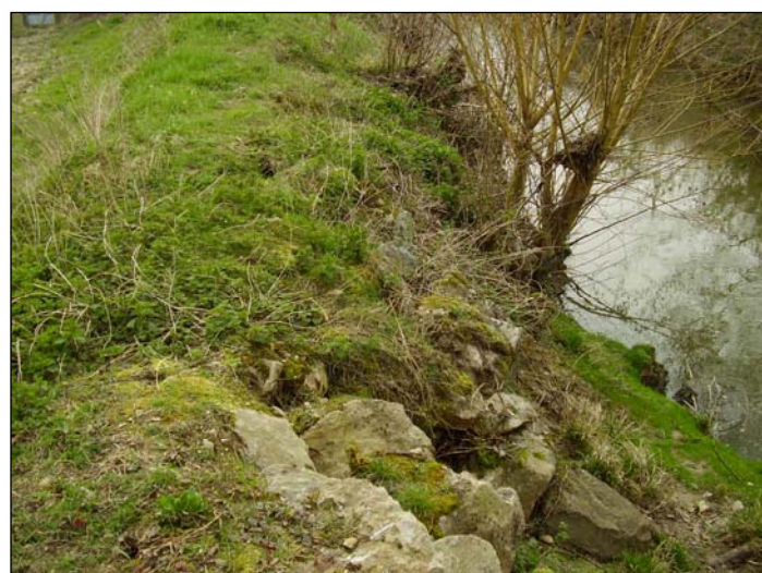
SEREINE – rive gauche – Tronçon S06g traitement inadapté de désordre / digue
