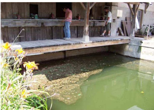
Vannage du moulin Neuf (Hydratec, 2006)
