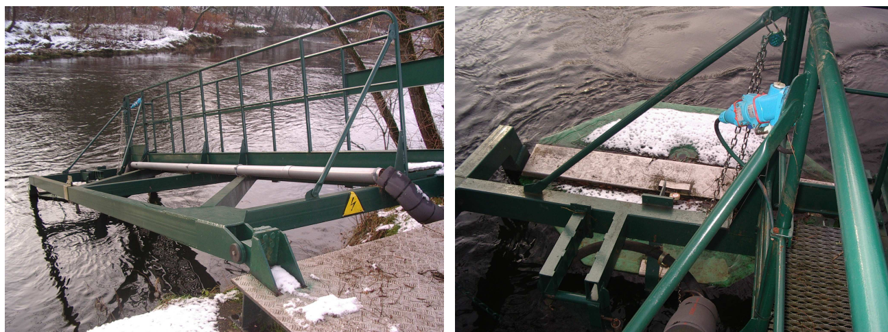
Figure 93 – Illustrations du bras HYDROMOBIL et du flotteur de prise d'eau de la station de Soba.
