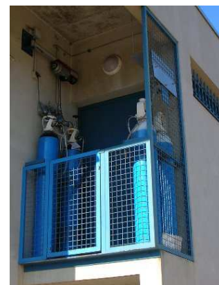
Figure 9 : Stockage de dioxygène pour minéralisation à la station de Ternay (69).
