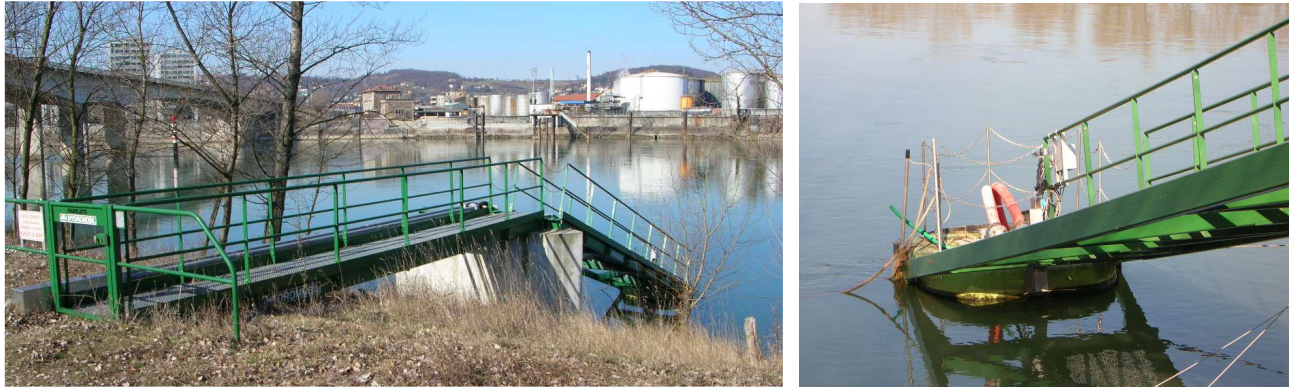
Figure 4 : Bras de prise d'eau et système de pompage de la station d'alerte de Ternay (69).
