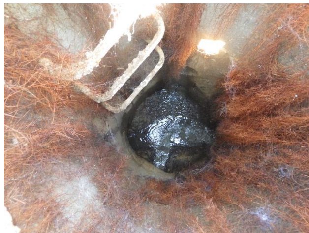
Racines dans regard – Regard 23 – Route des communaux
