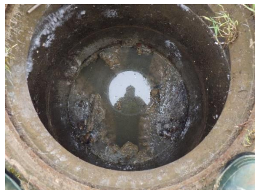
Mise en charge du réseau en amont du PR Arringes
