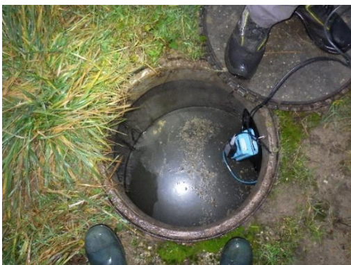
Mise en charge du réseau au droit du point de mesure n°4
