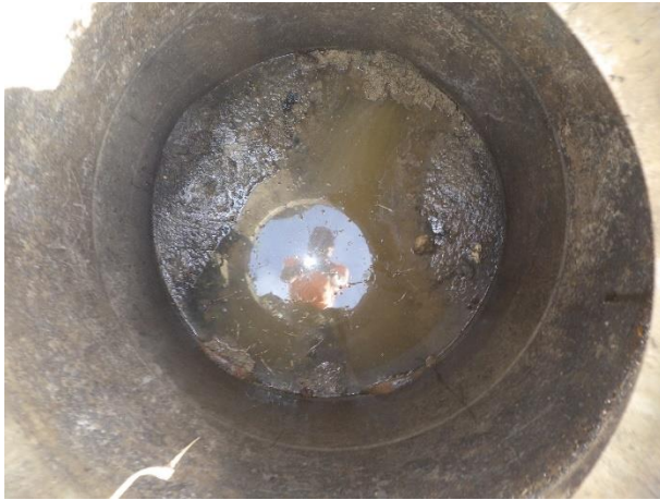
Mise en charge - Regard 205– Route d'Arringes
