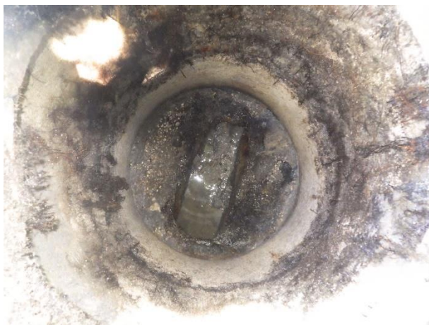
Racines dans regard - Regard 32 – Route des communaux
