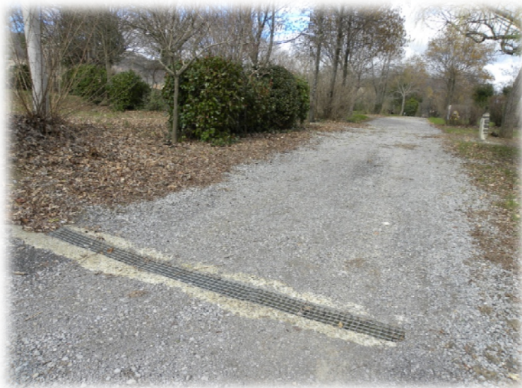
Grille avaloir présente au niveau des voiries du camping pour collecter les eaux pluviales (cliché du 04/03/2014)
