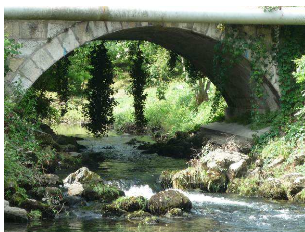
Ouvrage dégradé (FU22) : blocs de la rampe déstabilisés et mise à jour des fondations du pont
