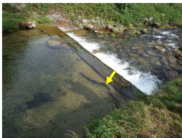
Légers affouillements sans conséquences sur la stabilité de l'ouvrage
