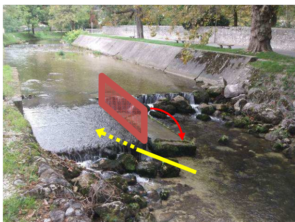
Ouvrage dégradé (FU18b) : bajoyer démantelé et radier sous cavé.
