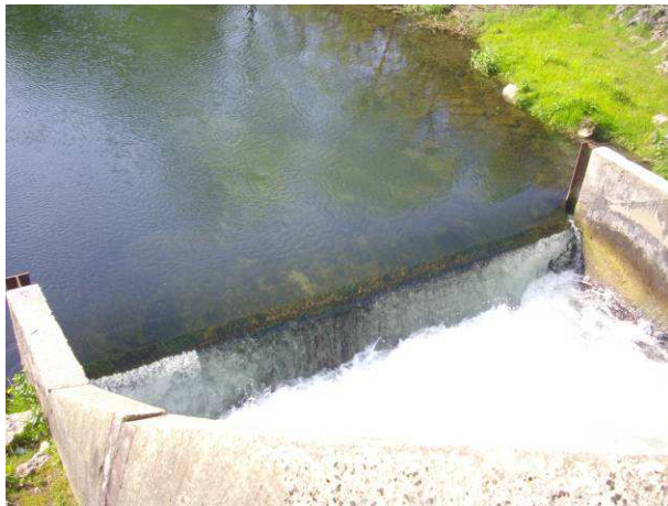
Deuxième ouvrage de maintien de la ligne d'eau sous un franchissement busé
