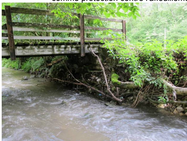
Exemple : Culée affouillée (avant)
