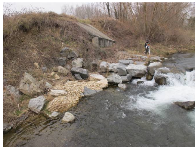
et berge dégradés
