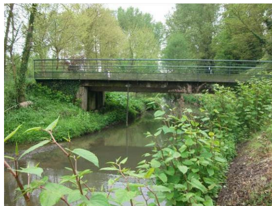
Foyer présent en amont du pont limite des secteurs COTT_01-COTT_02
