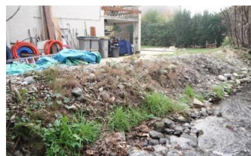
Digue érigée par les riverains, non compactée avec des matériaux divers
