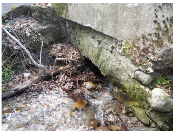
Ouvrage sous dimensionné
