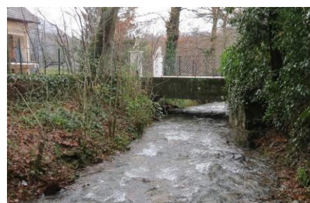
OAP8 : ouvrage en charge à partir de Q10 et débordements à partir de Q30.
