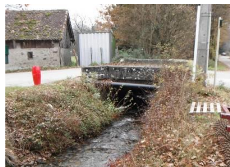
OAP7 : ouvrage dimensionné pour Q50
