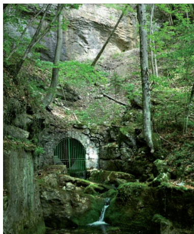
FIGURE 2.15 – Captage de la source de Fontaine Noire
