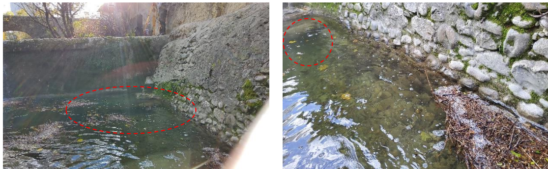
Figure 26 : Photographies du sous-cavage du seuil du pont vieux
