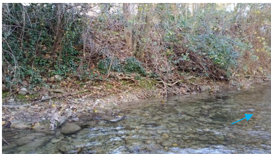
Etat de berge rive gauche : racines souterraines apparentes (PM297 amont)
