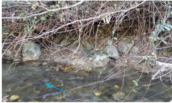
Zone en « coude » avant le mur rive droite du pont vieux (PM84 amont)
