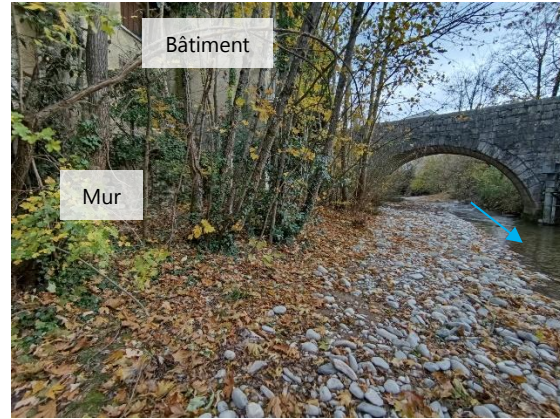
Atterrissement, mur et bâtiment (PM17 amont)
