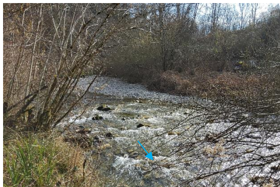
Atterrissement, radier et végétation (PM1390)
