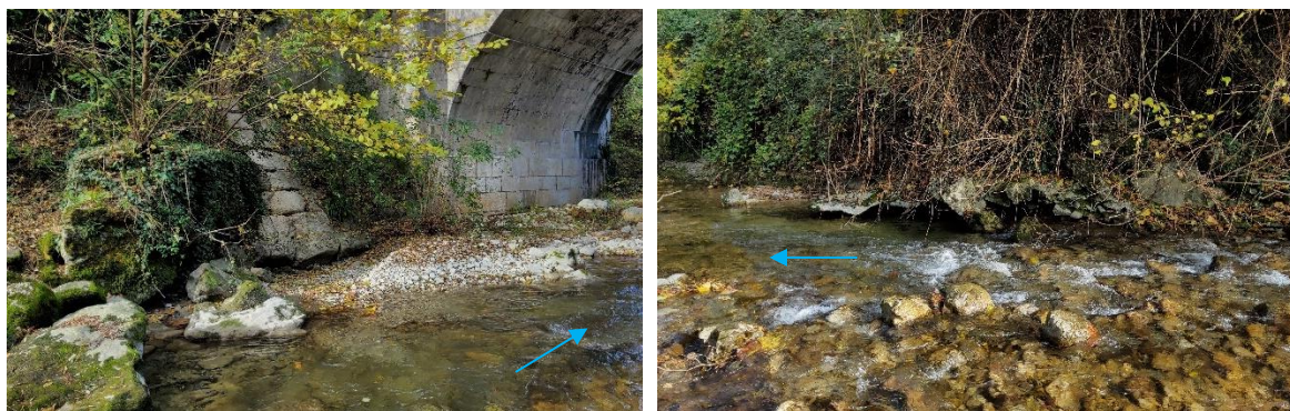
Figure 28 : Photographies de la stabilité du pont neuf
