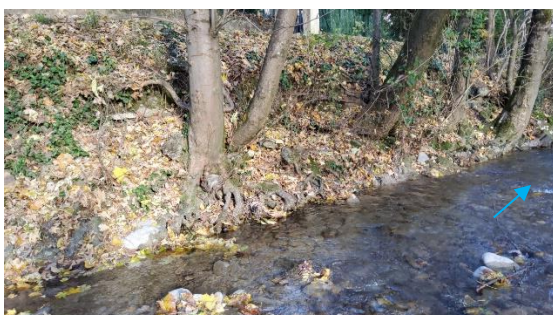
Etat de berge rive gauche : arbre aux racines exondées (PM188 amont)
