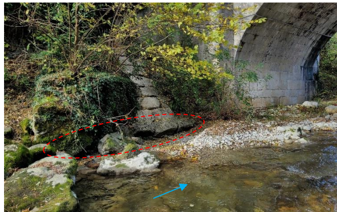
Affouillement sous le pont neuf (PM44 aval)
