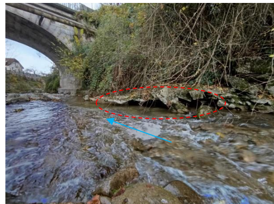
Affouillement en amont du pont vieux (PM40 aval)
