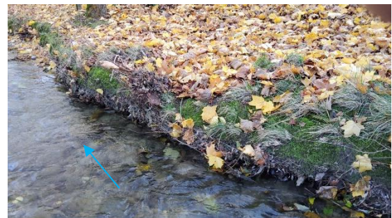
Etat de berge rive droite : sous berge avec racines apparentes (PM188 amont)
