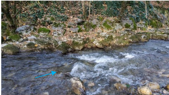
Etat de berge rive gauche (PM312 amont)
