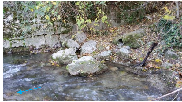
Dégradation du mur en pierres maçonnées rive droite (PM81 amont)
