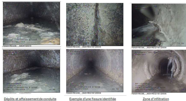
Figure 29 : Défaits Identifiés – Rue de la Piscine – Saint-Symphorien d'Ozon
