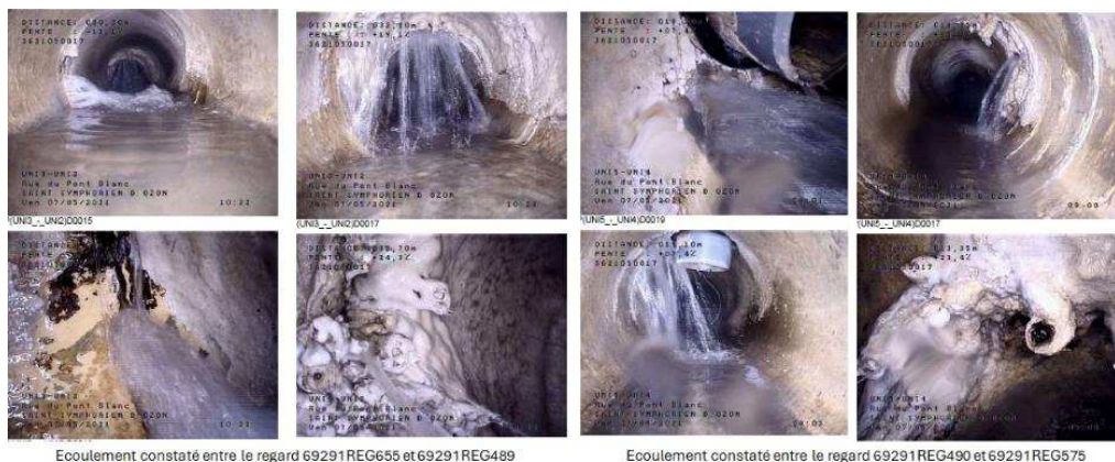
Figure 28 : Ecoulements d'eau constaté dans le collecteur - Rue du Pont Blanc – Saint-Symphorien d'Ozon
