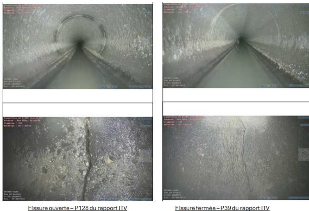
Figure 5 : Exemple de fissures ouvertes et fermées identifiés – Rue Henri Valencin - Chaponnay
