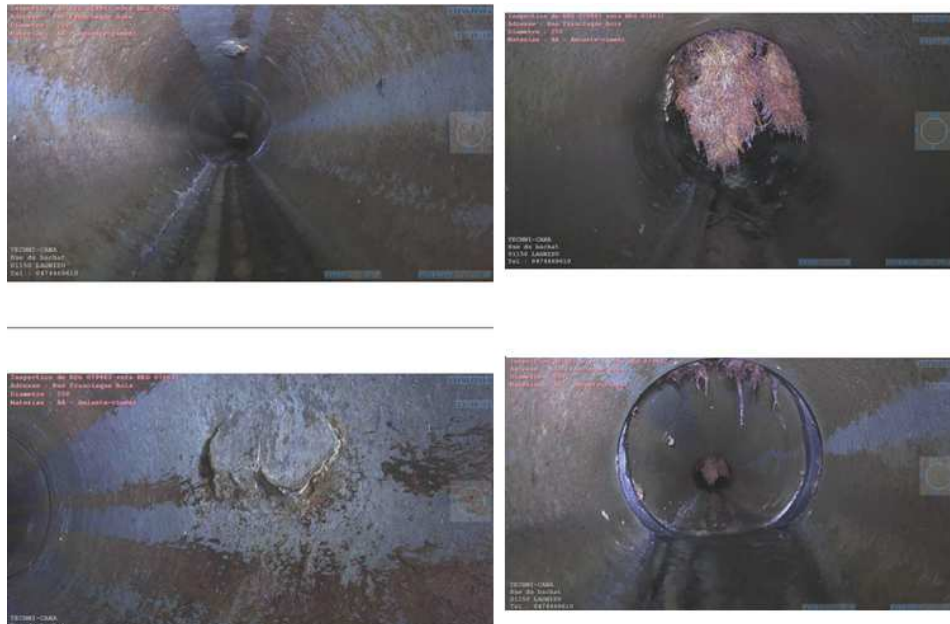
Figure 23 : Défauts majeurs identifiés – Rue Francisque Bois
