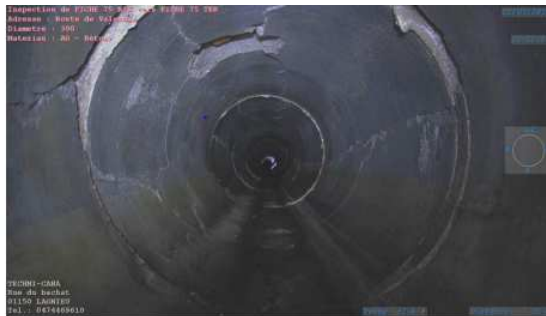
Rupture et fissures identifiées – P32 du rapport ITV
