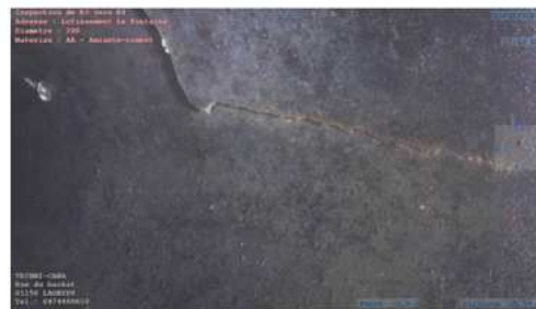
Rupture hélicoïdale – P17 du rapport ITV
