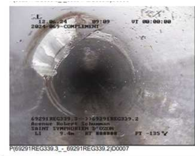
Raccordement défectueux – P19
