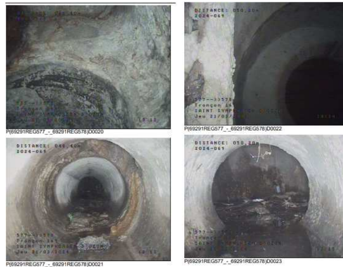
Dégradation de surface et dépôts
