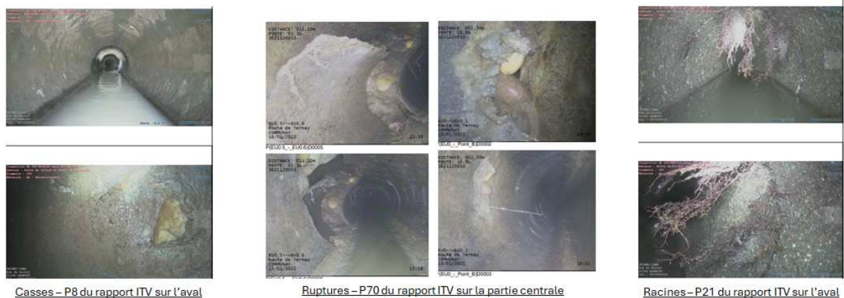
Figure 13 : Défaits identifiés Route de Marennes – Communay
