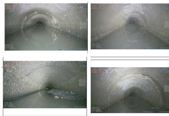
Niveau d'eau conséquent – P26, P30, P35 du rapport ITV
