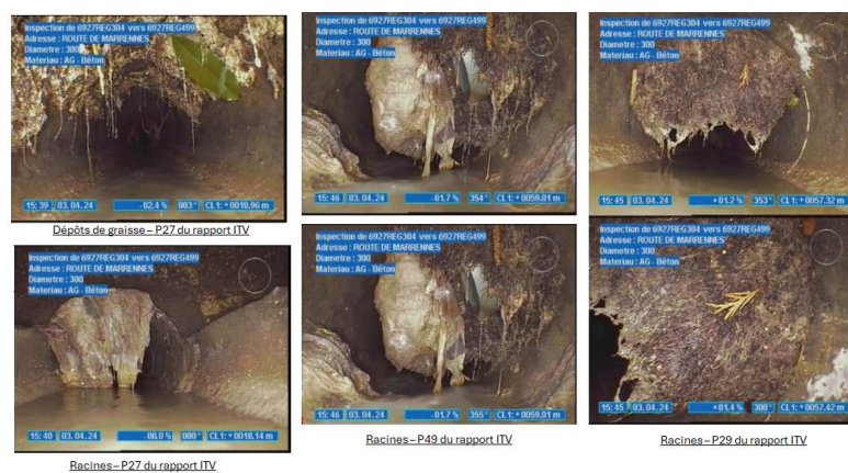
Figure 11 : Défauts de racines et de graisses identifiés sur le Tronçon 26 - Communay
