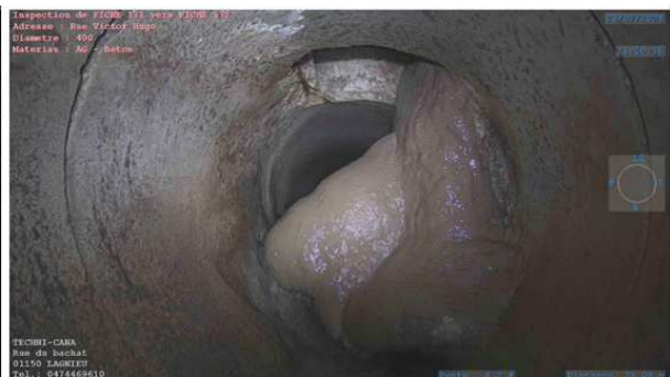
Aval de la concrétion – P99 du rapport ITV
