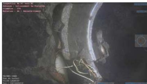
Rupture de conduite – P23 du rapport ITV
