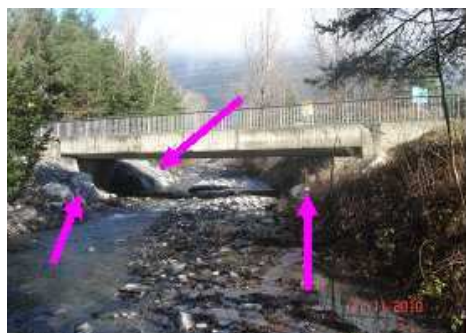
Cette photo montre des blocs et matériaux divers en pied de piles qui limitent la capacité de l'ouvrage
