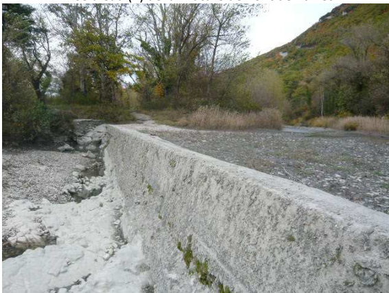
Prise d'eau de Bourdeaux
