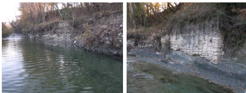
Photographie 5 Enfoncement du profil en long du Roubion supérieur à 1 m
