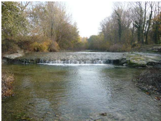
Seuil infranchissable au niveau de Charols (photo Dynamique Hydro).
