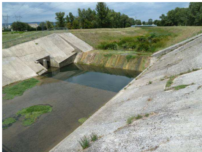
Seuil infranchissable – Poste EDF de Châteauneuf-du-Rhône
