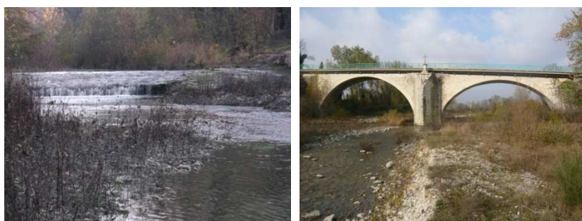
Photographie 8 Seuil déstabilisé en aval du pont de Charols et dépôts au droit du pont de Charols
