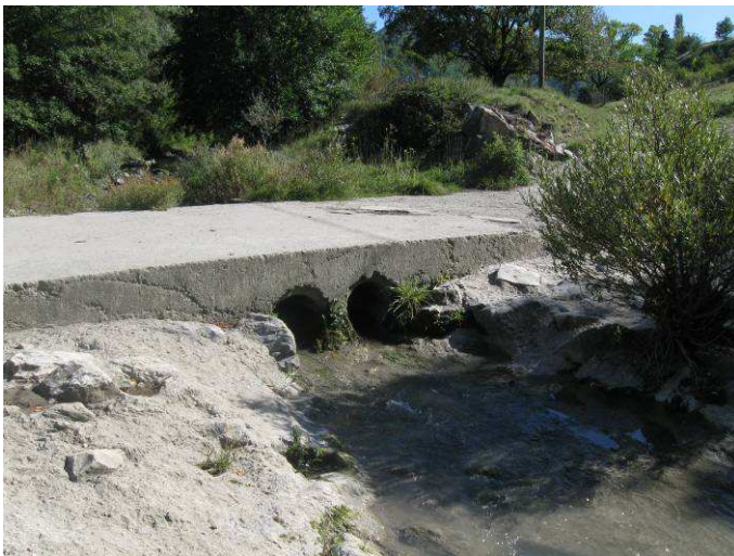
Gué au niveau du lieu-dit les Marroux. La faiblesse de la lame d'eau sous l'ouvrage peut être pénalisante pour la remontée des poissons.
