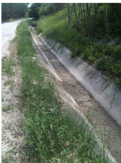
Autre fossé en pied de talus de la RD : la réalisation de buses dans le talus permettrait de faciliter l'écoulement des eaux
