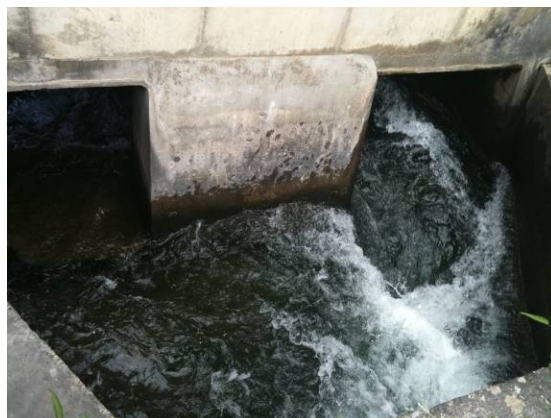
Sortie du système de pompage
