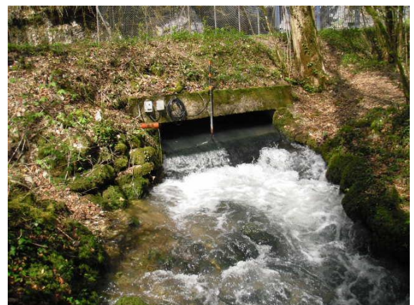
Surverse du captage de la source de la Douai
